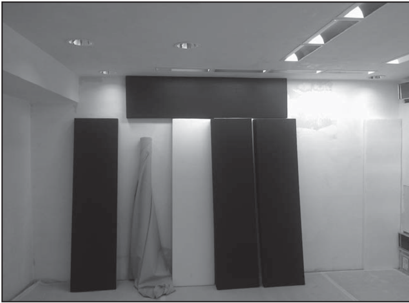
Fig. 18 – Pannelli di materiale assorbente
