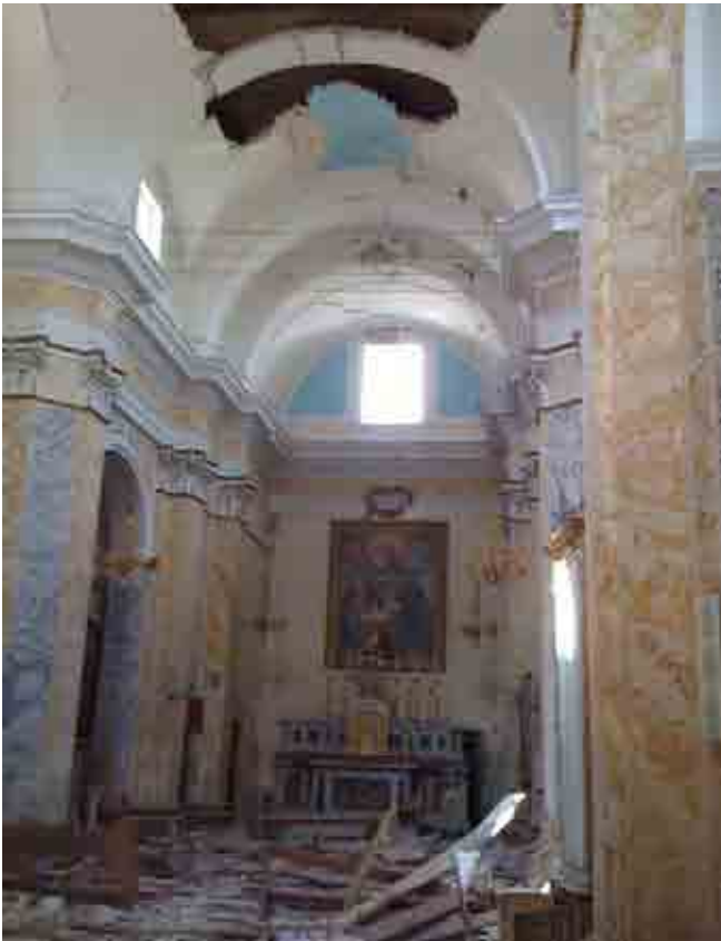
L'interno della chiesa di San Giacomo Maggiore ancora invaso dalle macerie provocate dal sisma del 2009.
