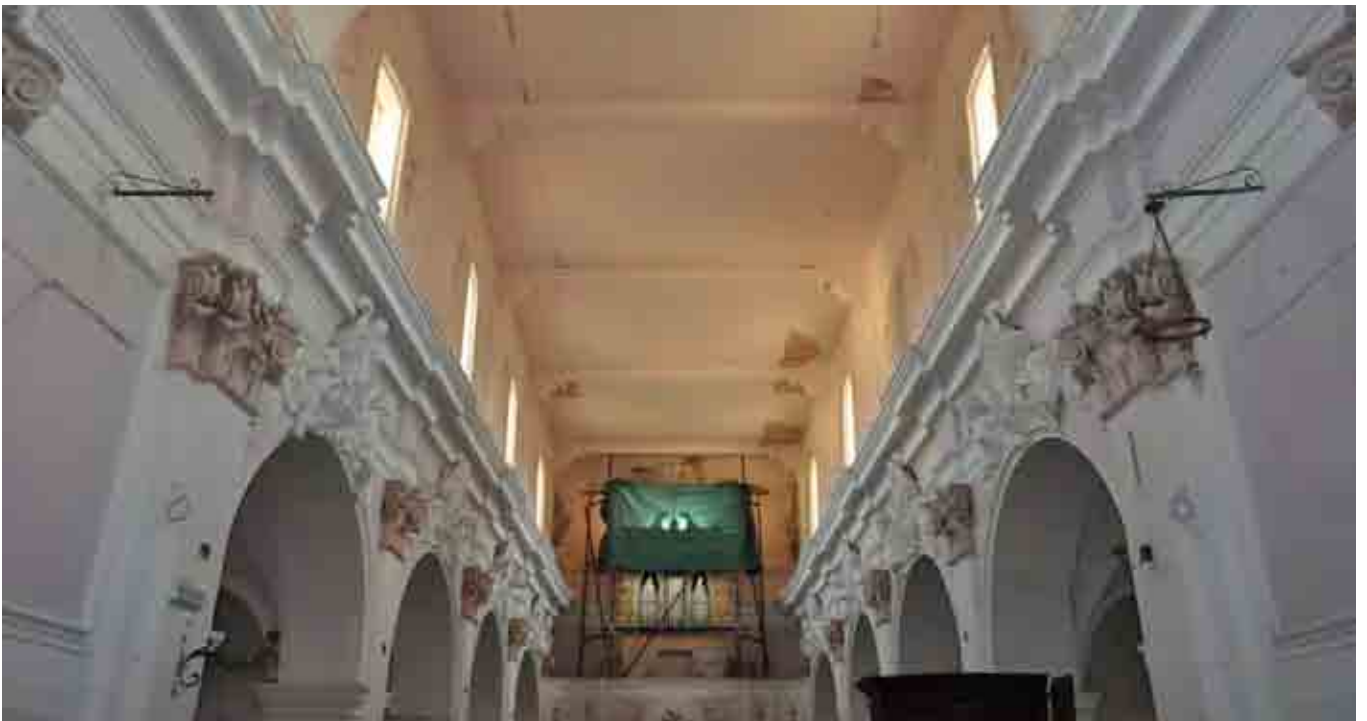
Una vista degli interni della Chiesa di San Lorenzo nella frazione di San Lorenzo di Beffi, Comune di Acciano (AQ) dopo il sisma del 2009.
