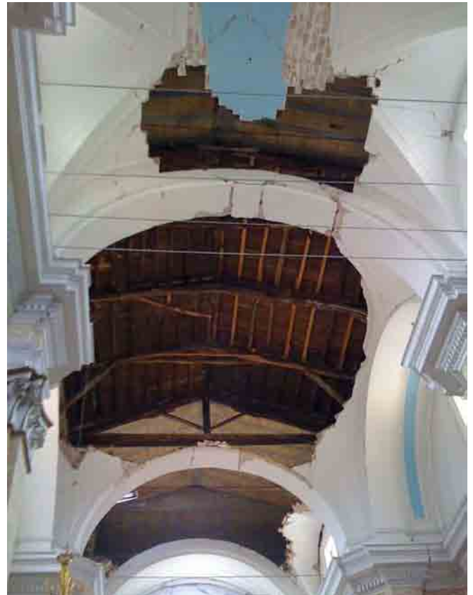
Il crollo delle volte a crociera in mattoni in foglio di copertura all'aula della chiesa.
