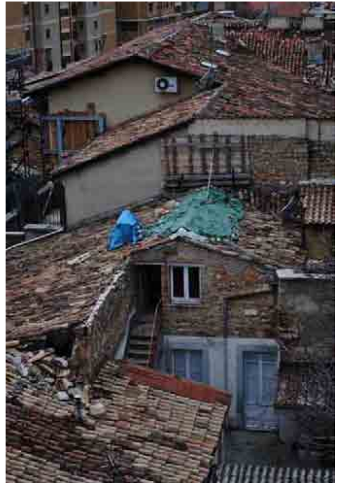
Nella foto a sinistra e in quella sopra: alcune viste dei tetti di un aggregato rilevato nella "zona rossa" del centro storico di L'Aquila. Quando non è possibile rilevare strumentalmente o in modo diretto i sistemi di copertura, è comunque importante documentarli fotograficamente.
