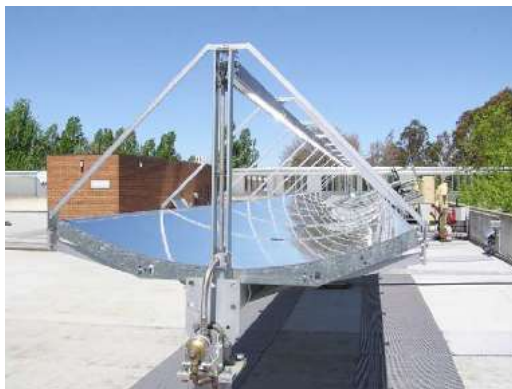
Figura 8: Collettore CHAPS installato presso un edificio dell'ANU
