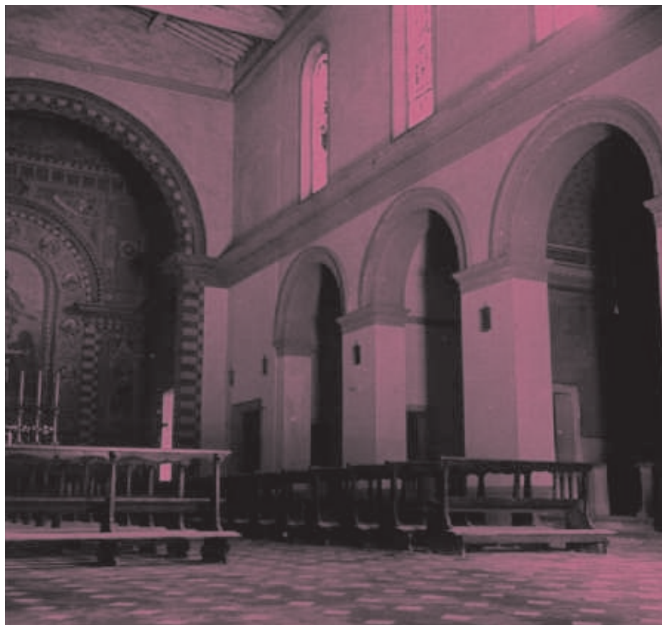
Figura 1. Interno della ottocentesca chiesa del Sacro Cuore, come si presentava prima dell'intervento di Lando Bartoli.
