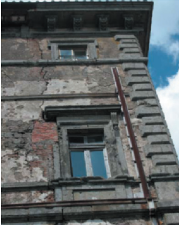
Figura 9 - Particolare della lesione verticale nella zona prossima allo spigolo Sud-Est.
