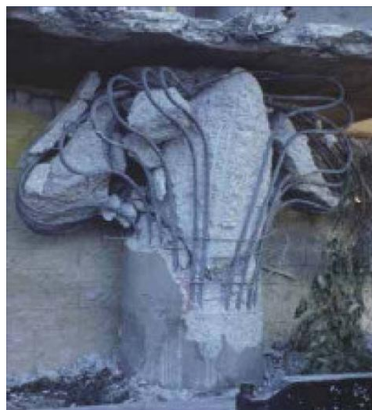
Figura 1.16: Effetto della mancata staffatura degli elementi strutturali
