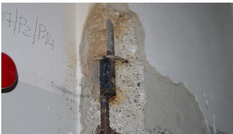
Figura 5.47: Particolare del ripristino della porzione di barra prelevata
