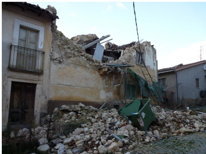
Figg. 1, 2 – Edifici in crollo (“zona rossa”) nell’ambito A del capoluogo
