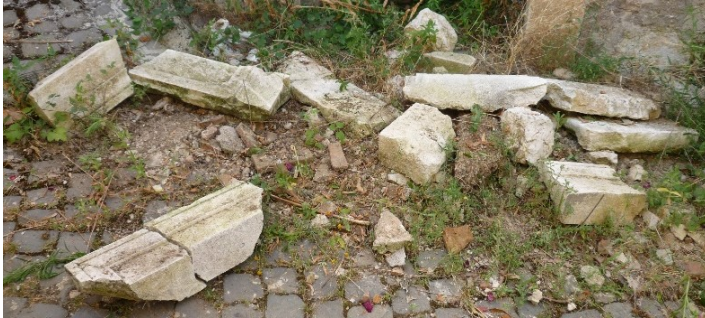
Fig. 20 – Casentino, fregi architettonici caduti a terra
