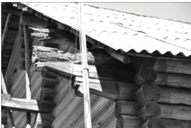
Particolari costruttivi del sistema di travi a sbalzo di sostegno per la pesante copertura a capanna.
