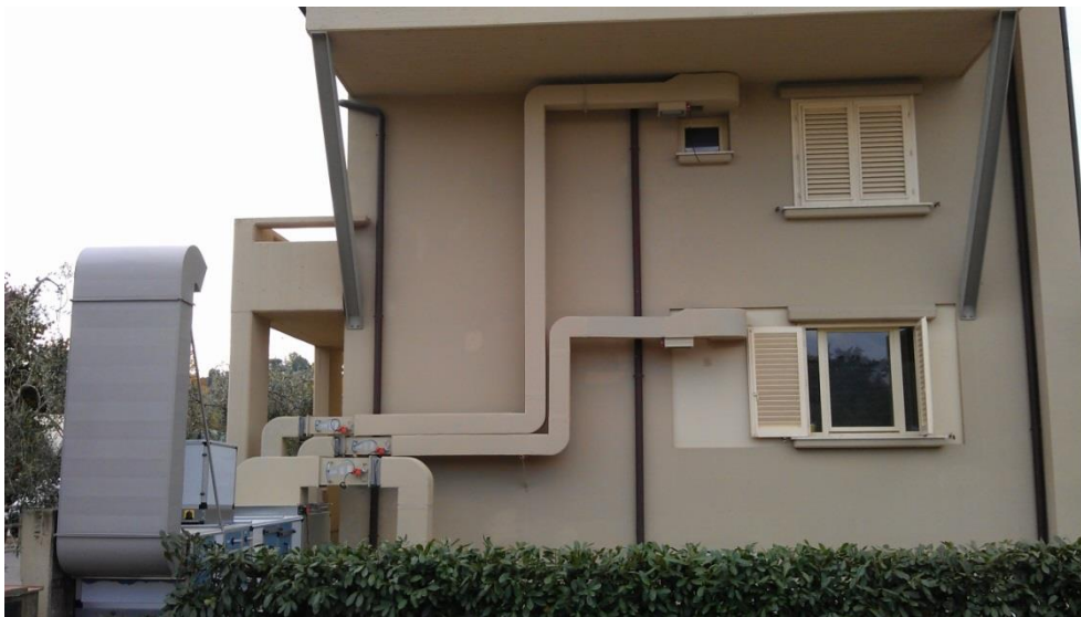
Figura 4-27 Installazione Energy Box – Firenze – sistema HVAC installato
