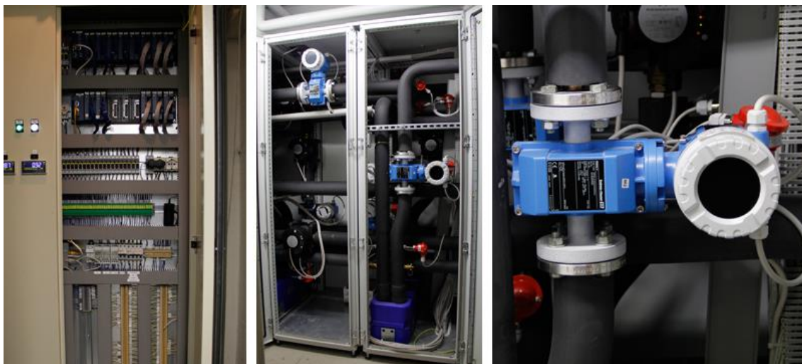
Figura 3-15 Installazione EB di Bronzolo, Energy Box
