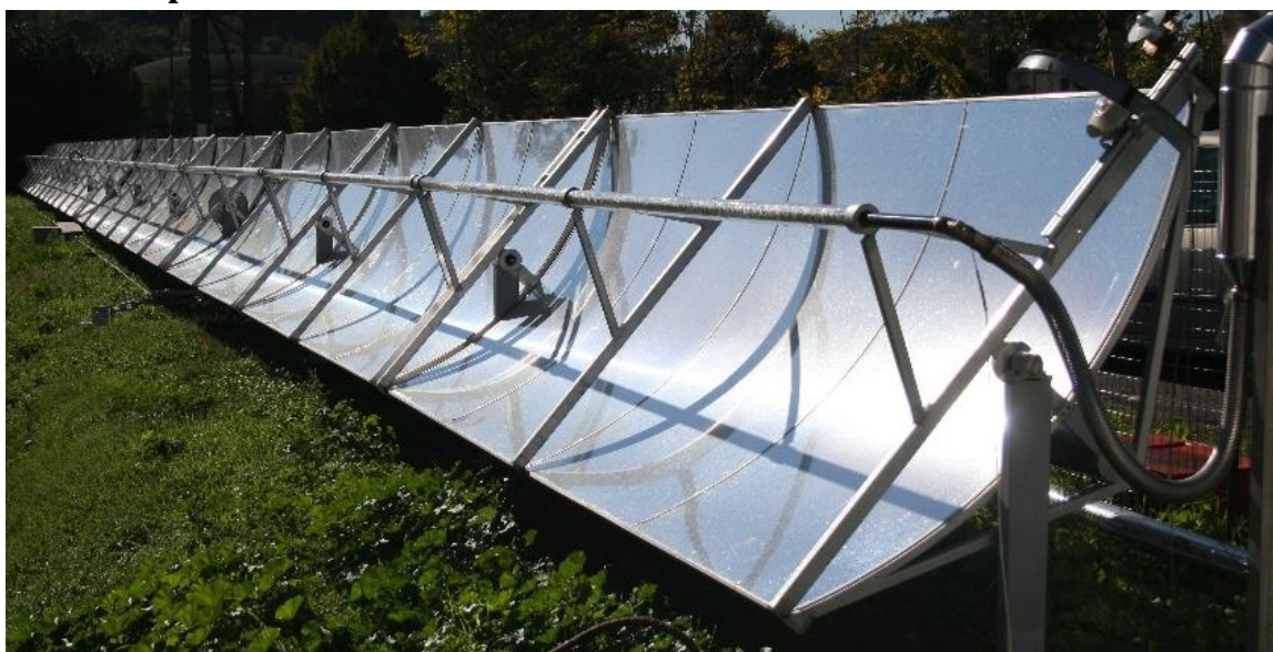
Figura 4-16 Installazione Energy Box – Firenze – Campo solare
