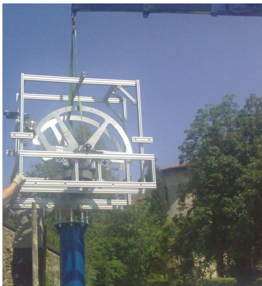
Figura 3-9 Installazione del tracking.
