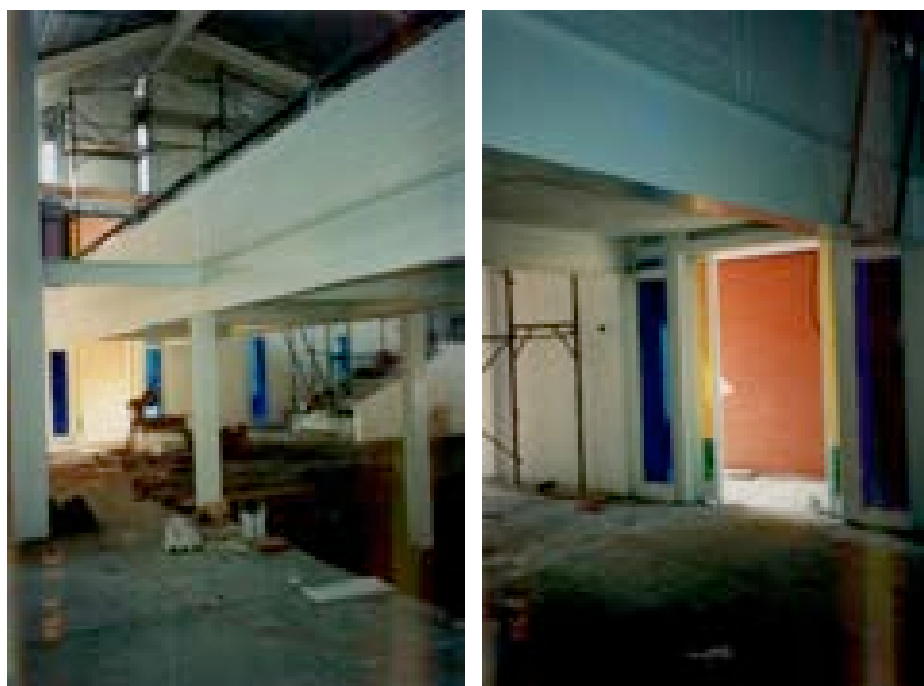
Figura 1645 – SX, la posa in opera delle finestre – (AABS-1998_03_31 - Foto Santa Rosa_01) Figura 1646 – DX, la posa in opera della porta di ingresso – (AABS-1998_03_31- Foto Santa Rosa_06)
