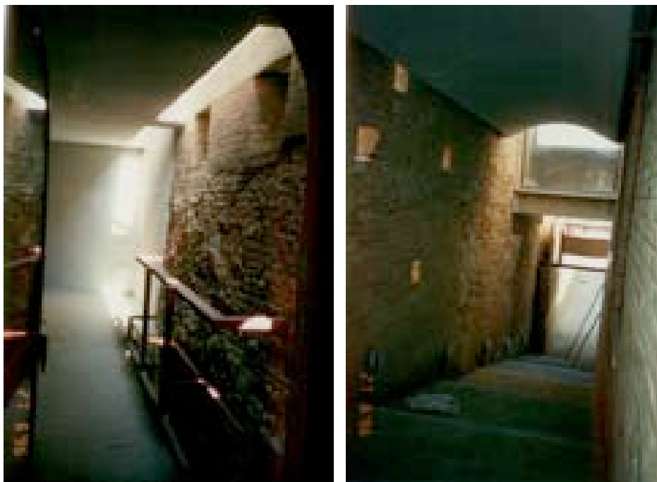
Figura 1125 – SX, la lama di luce interna all'ingresso – SAL 1996 (AABS-1996 Valdimontone_27) Figura 1126 – DX, la rampa di accesso interna – SAL 1996 (AABS-1996 Valdimontone_24)
