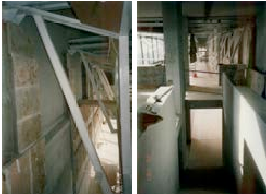
Figura 1132 – SX, la realizzazione delle finiture interne – SAL 1997 (AABS-1997 Valdimontone_15) Figura 1133 – DX, la realizzazione delle finiture interne – SAL 1997 (AABS-1997 Valdimontone_17)
