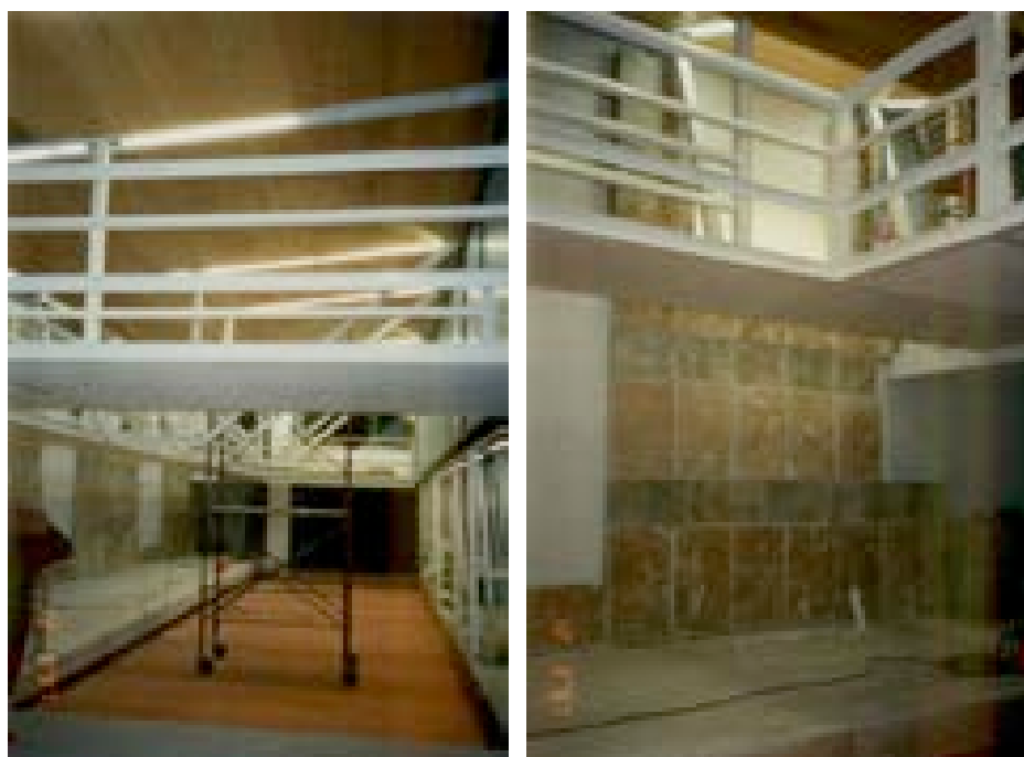
Figura 1142 – SX, l'illuminazione interna – SAL 1997 (AABS-1997 Valdimontone_71)
