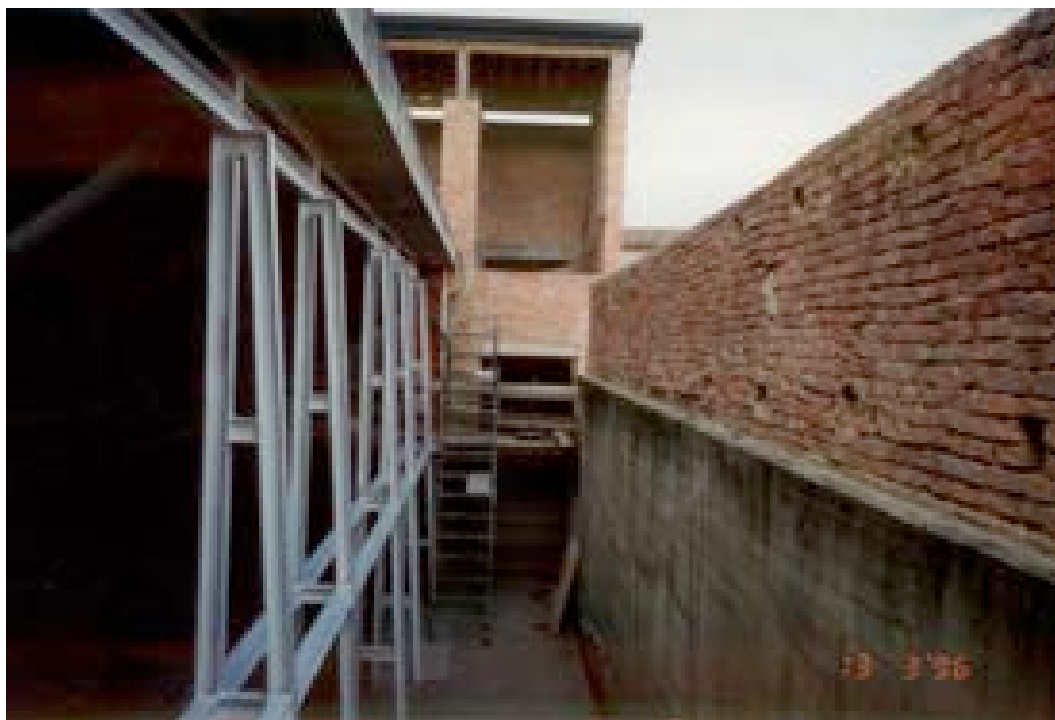
Figura 1127 – SX, la struttura metallica prima del montaggio delle vetrate e la controparete in c.a. prima del rivestimento in tufo – SAL 1996 (AABS-1996 Valdimontone_48)
