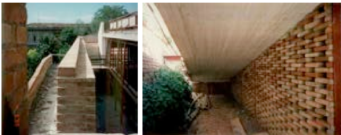
Figura 1115 – SX, la rampa vista dall'ingresso principale – SAL 1995 (AABS-1995 Valdimontone_124) Figura 1116 – DX, il rivestimento inferiore della rampa esterna – SAL 1995 (AABS-1995 Valdimontone_126)
