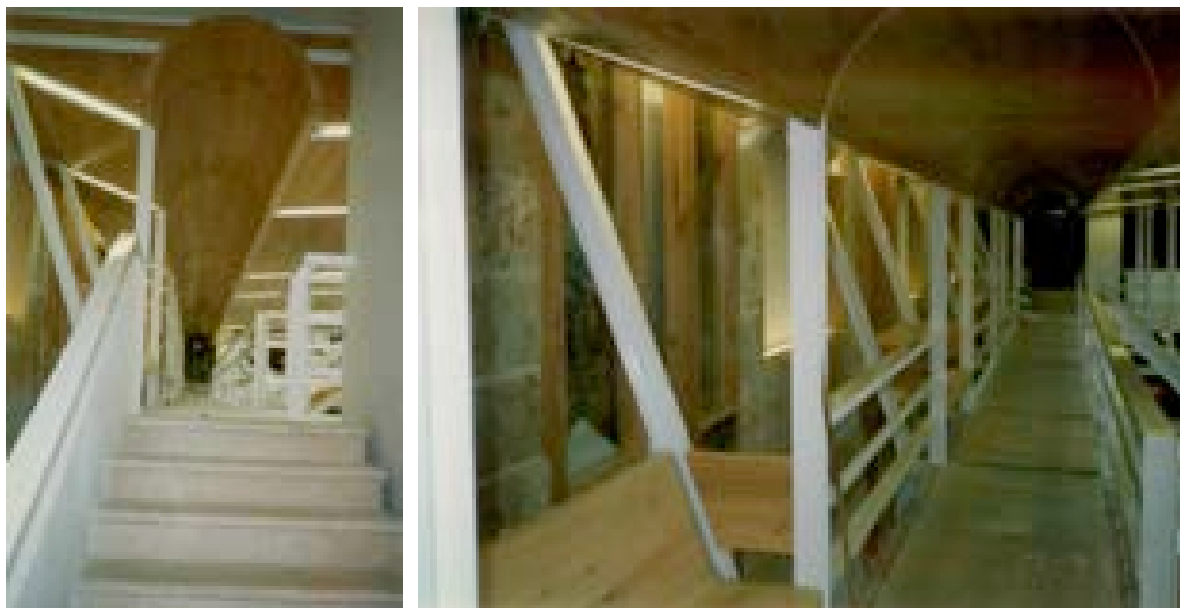
Figura 1140 – SX, l'illuminazione interna – SAL 1997 (AABS-1997 Valdimontone_103)
