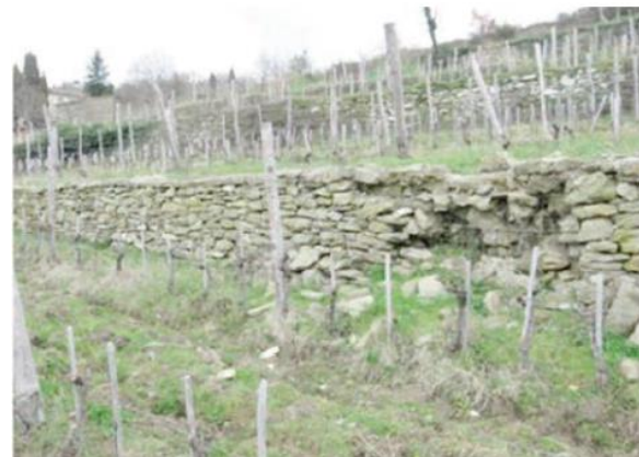
Fig. 2.3 Mero di sostegno in stato di abbandono in un vigneto.
