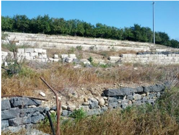
Fig. 2.2 Muretti di sostegno in stato di abbandono in un agrumeto.
