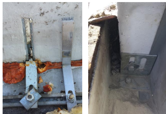
Figura 9. Particolari connessione pannello verticale alla struttura (sinistra) e connessione trave alare - trave di bordo (destra).
