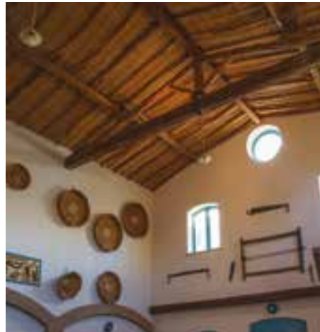
Fig. 6 Traditional truss in Samassi, Sardinia, Italy (photo: Associazione Nazionale Città della Terra Cruda).
