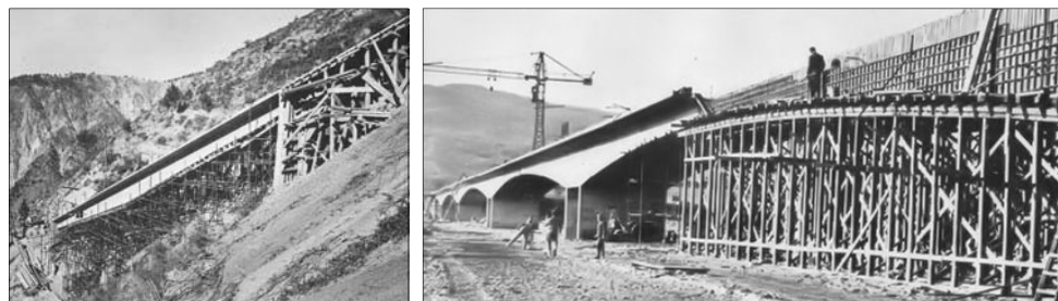
Figg. 6 e 7 - Ponte per l'impianto del Mucone ( L_{tot} 54.5 m, 8.5 + 37.5 + 8.5, l_{imp} 2.7, h_c 1.8 m, h_p 1.0 m, i_L 38.6%) in Calabria (I,1950) realizzato con sistema di precompressione Freyssinet (Zorzi, 1981) - Ponte sul fiume Bradano ( L_{tot} 357.0 m, 29.5 + 5 x 59.6 + 29.5, l_{imp} 8.8, h_c 1.0 m, h_p 3.0 m) (I,1957-58) con impalcato, realizzato con sistema di precompressione Morandi, caratterizzato da cerniere in mezzzeria ed incastrato su pile a doppia lama di bassa altezza. (Bologna & Maddalena, 1962)
