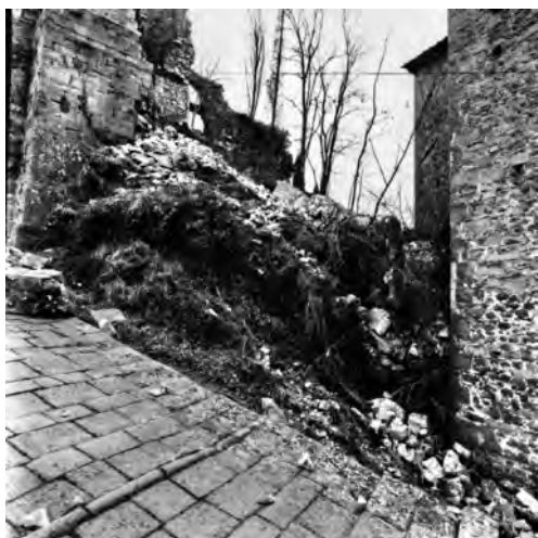
Fig. 3 - Il crollo della Rocca. Foto conservata all'archivio fotografico della Soprintendenza (Soprintendenza per i Beni Architettonici di Firenze, riproduzione fotografica n. 88593. Su gentile concessione del Ministero per i Beni e le Attività Culturali)
