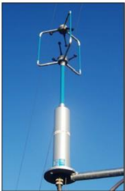
Fig.II.8. Anemometro ad ultrasuoni per la misura della velocità del vento.
