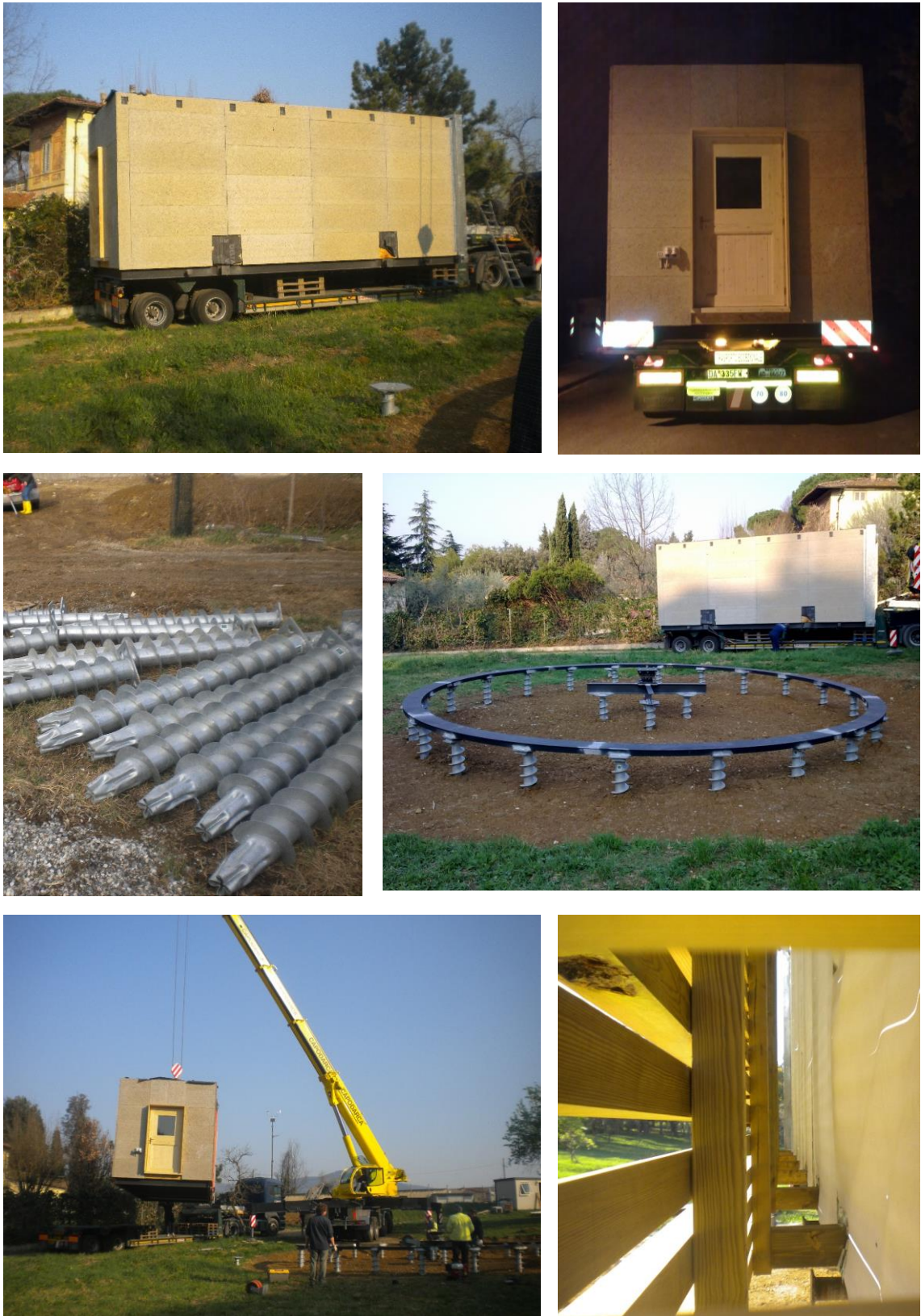
Fig.II.24. Trasporto della Test Cell presso il Parco del Plesso di Santa Marta di Ingegneria. Posa del sistema di fondazione e della base girevole su cui è stata appoggiata la struttura del laboratorio. Dettaglio della schermatura solare lineare applicata ai prospetti laterali (in basso a destra).
