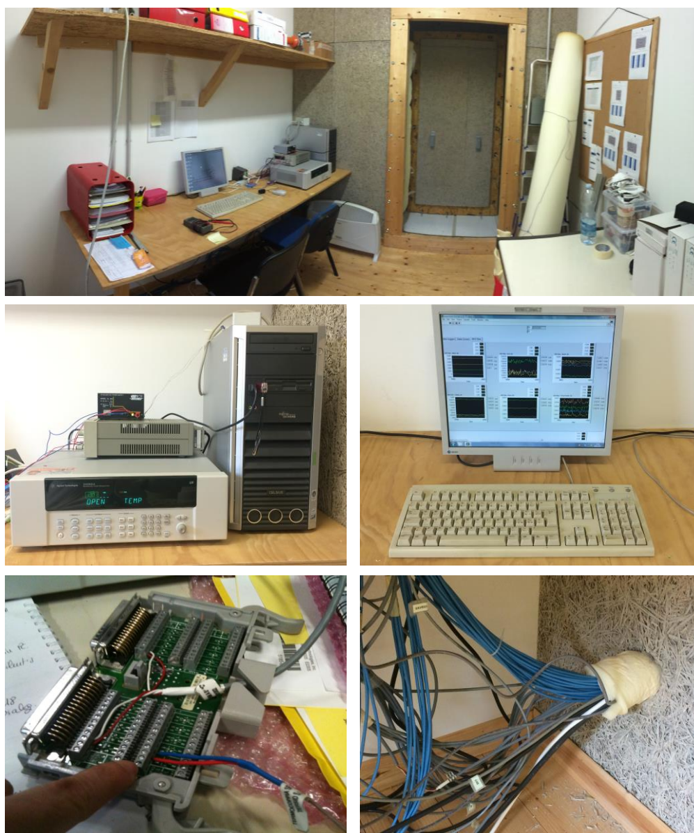
Fig.III. 16. Unità di controllo e di acquisizione DAQ posta in service room costituita da un realizzata con l'ausilio di un data logger HP Agilent 34980A e di un software di controllo (Labview) (in alto); collegamento di un sensore al multiplexer HP 34921A per la misura di termocoppie (in basso a sinistra); il passaggio dei cavi dall'unità di acquisizione posta in service room, alla test room avviene mediante un foro praticato nella parte divisoria tra i due ambienti opportunamente sigillato per evitare infiltrazioni d'aria durante i test (in basso a destra).
