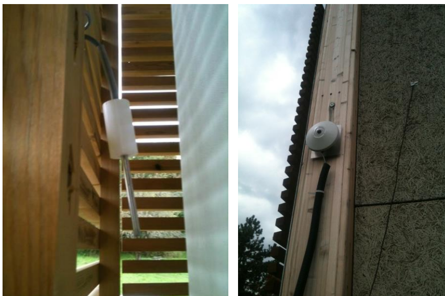
Fig.III.4. Sensori per il monitoraggio dei parametri climatici e ambientali esterni (piranometro, tacuanometri e termoresistenze); stazione metereologica del DIF collocata in prossimità della Test Cell, nel parco del Plesso di Santa Marta.
