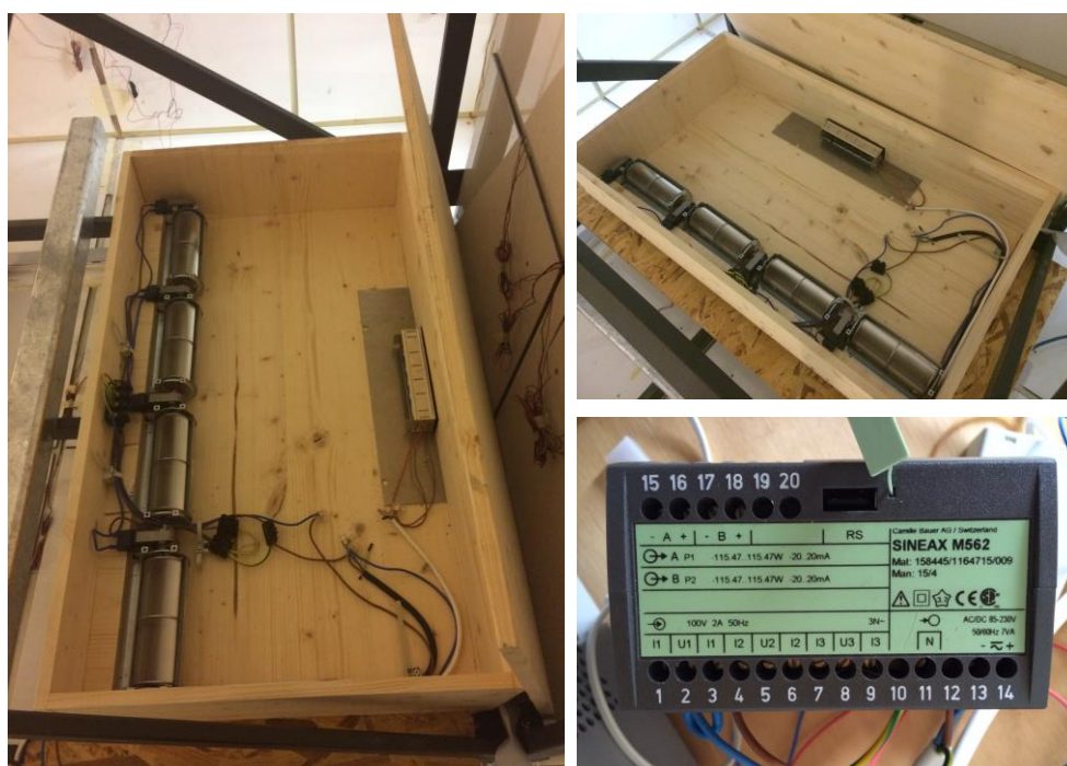
Fig.III.14. Le immagini illustrano l'impianto di riscaldamento posto in Test Room: le diverse unità che lo compongono sono collocate all'interno di un box in legno posto dietro la porta della test room.
