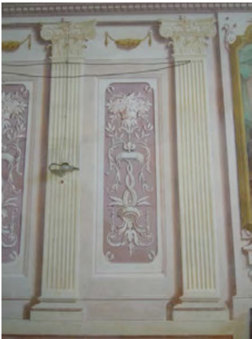
Fig. 192 Fibbiana (Montelupo Fiorentino), Oratorio di San Gaetano, particolare della decorazione delle pareti laterali con specchiature con decorazioni "a candelabra" a finto stucco. (Foto dell'autore)
