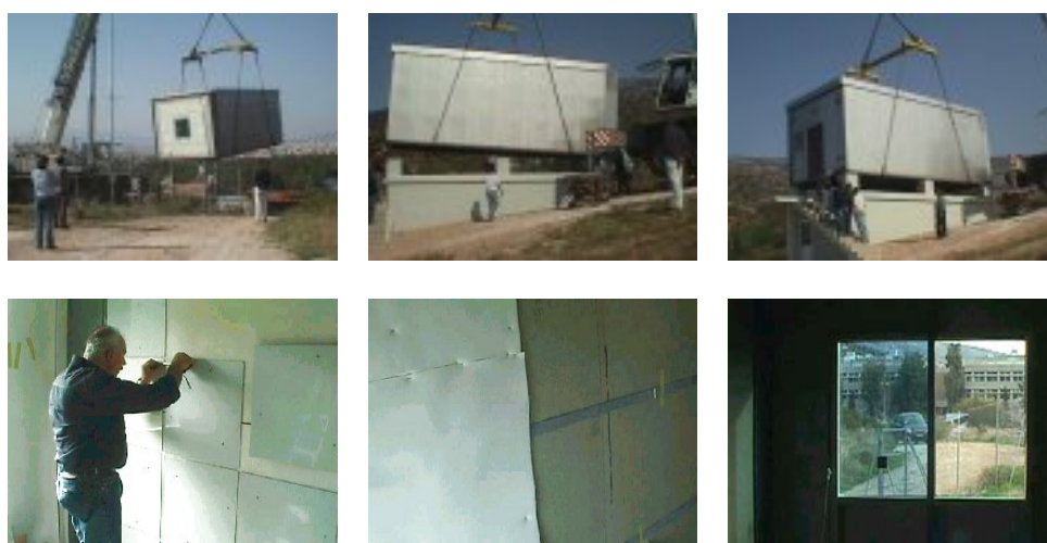
Fig.I.79. In alto. Immagini della posa in opera della test cell. In basso, montaggio delle flux tiles sulle pareti interne della cella. Infine, prove su componenti vetrati. Credits. NKUA
