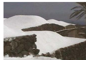
Fig.I.138. Gli estradossi delle cupole adiacenti, operano da fenditure entro le quali l'acqua piovana può scorrere fino ad una prospiciente cisterna interrata.
