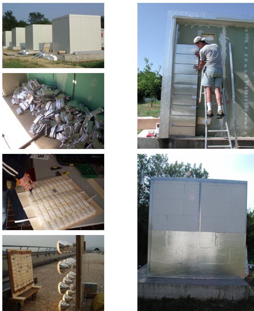
Fig. I.70. Immagini dei box e dei materiali a cambiamento di fase utilizzati sia per i componenti di involucro esterni che per i componenti a pavimento radiante, all'interno. Credits: A. Carbonari
