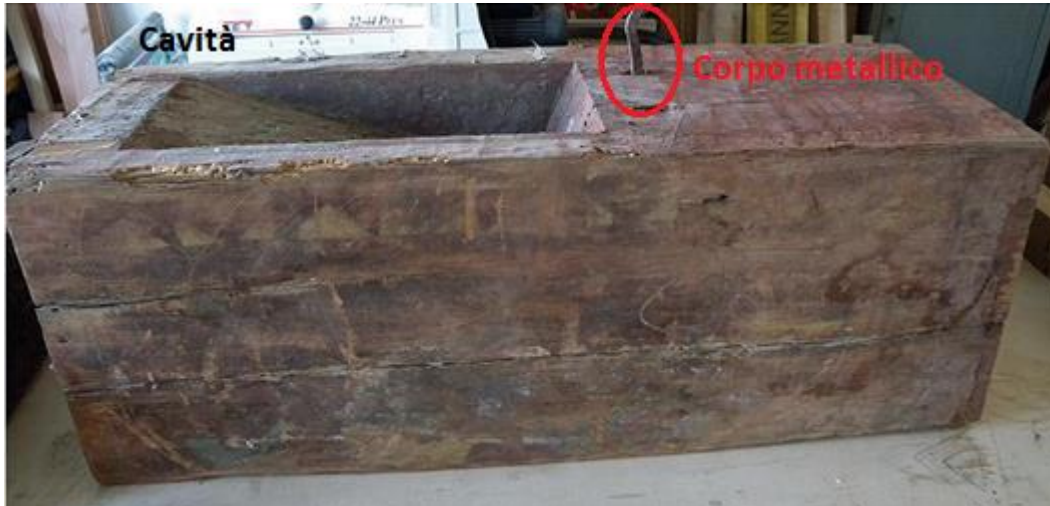
Figura 19 – Campione trave con decadimento strutturale
