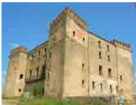
Fig. 2a- Castello di San Lorenzo del Vallo prima del restauro.
