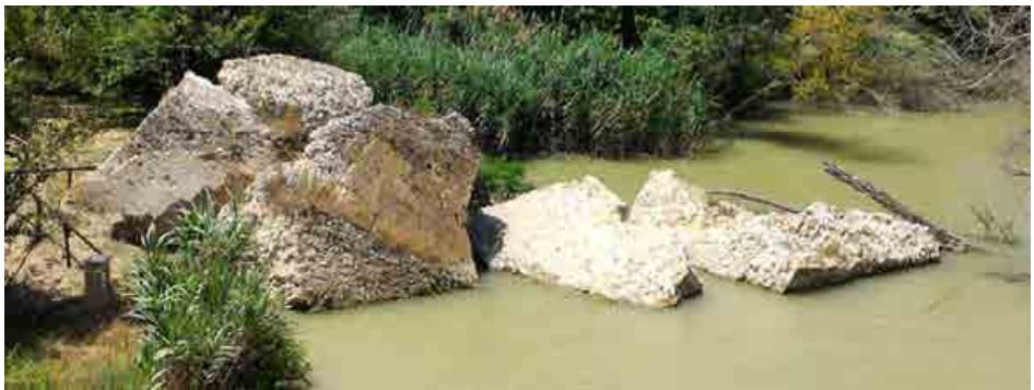
Fig. 5- Torre Moro. La struttura superstite è crollata nel fiume (foto giugno 2016).
