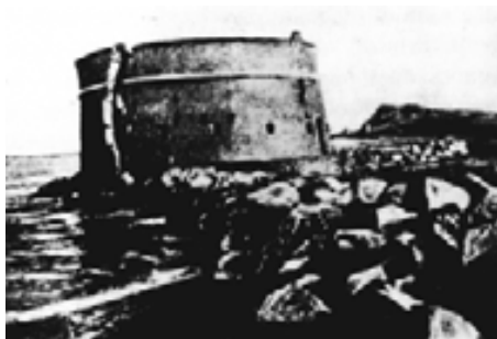
Fig. 6– Il forte gravemente lesionato e in irrimediabile decadenza all’inizio del Novecento (www.ceraunavolta-ps.com).
