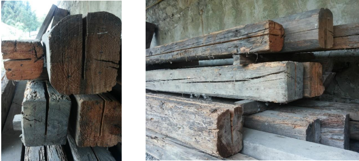
Figura 11 - Il campione di travi antiche, già oggetto di studio sugli effetti d'indebolimento dovuti al taglio (Cavalli 2012)
