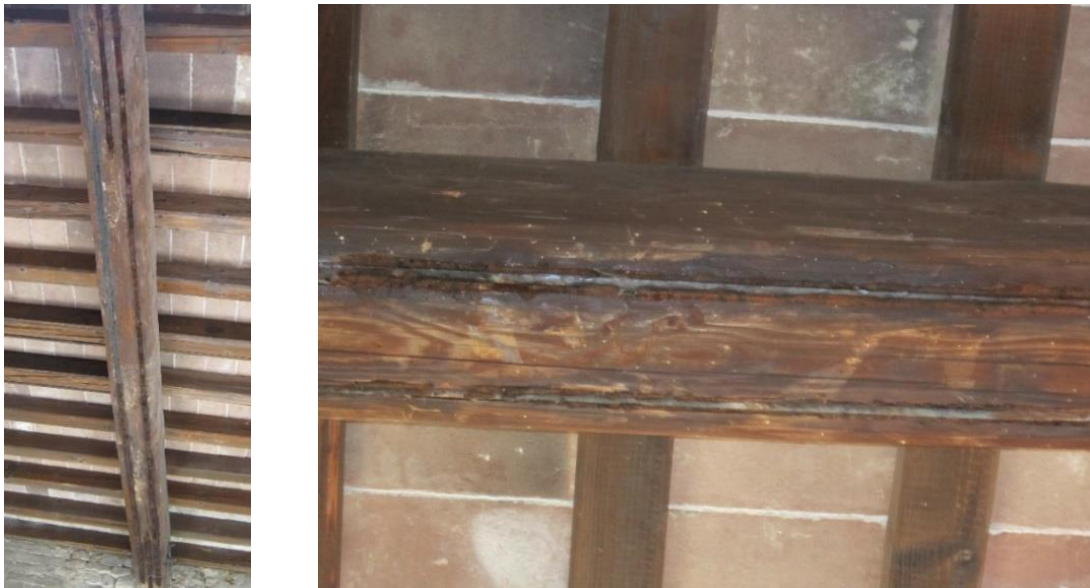
Figura 1 - Rinforzo dell'intradosso delle travi principali di un solaio ligneo mediante l'applicazione di lamine di acciaio interne, effettuato nel 2010. Con il tempo la resina di copertura delle lamine si è staccata lasciando a vista l'acciaio sottostante. Loggia coperta di Palazzo Pretorio a Certaldo (Fi).
