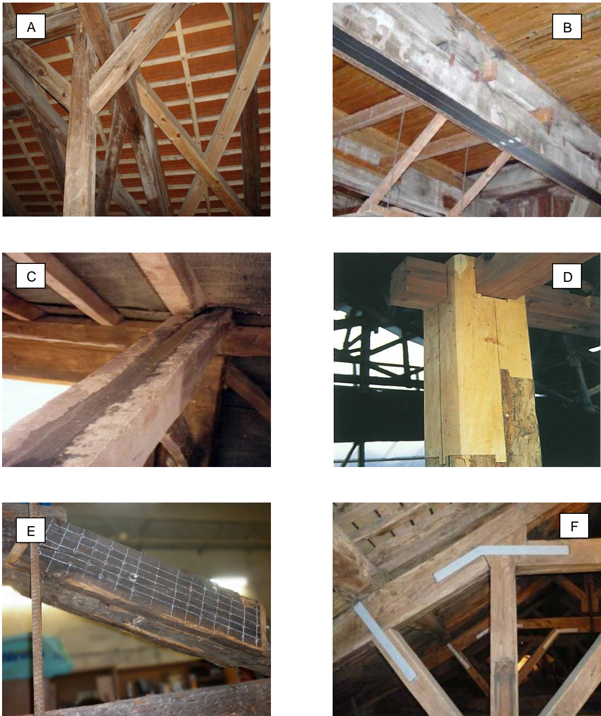
Figura 2 - Alcune tipologie d'intervento di restauro eseguite su elementi lignei antichi: A sostituzione di elementi deteriorati (da Pinto 2008); B e C rinforzo tramite l'applicazione di fibre di carbonio esterne (da Franke et al. 2015) e mediante l'inserimento di trefoli d'acciaio ( http://www.timber-repair.co.uk ). Esempi di riparazione e di ripristino della continuità strutturale mediante: D protesi di legno (da Uzielli 2004), E interventi localizzati di riparazione di una zona danneggiata meccanicamente tramite l'aggiunta di nuovi elementi lignei avvitati ai lati del puntone di una capriata (da Cibecchini et al. 2016a) e F rinforzo di unioni tramite piastre d'acciaio (Ilharco et al. 2010).
