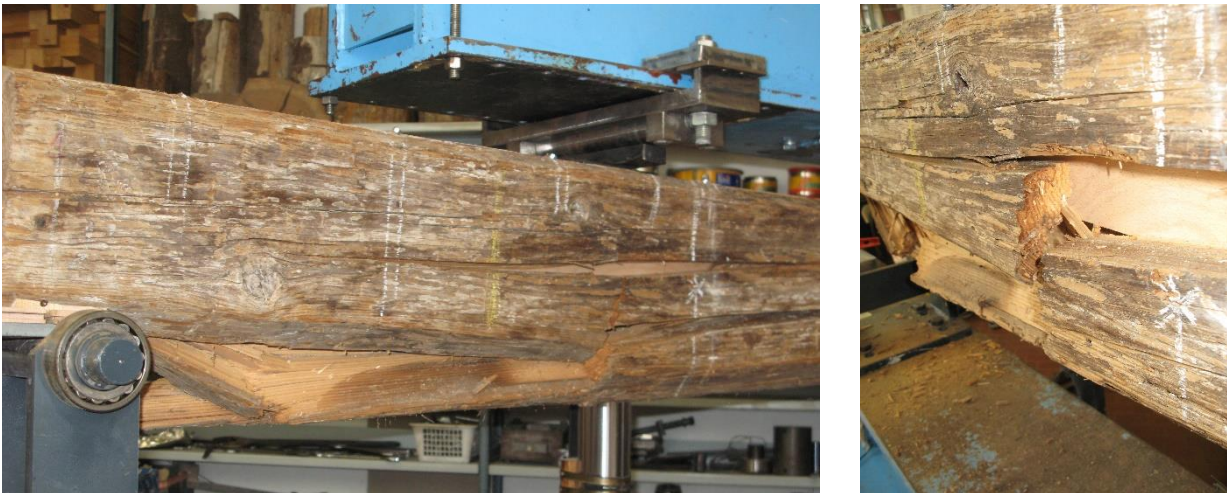
Figura 47 – Prova di rottura dell'elemento T09. La foto di sinistra mostra il cedimento nella trave in corrispondenza dell'appoggio. Nella foto di destra è possibile osservare la tipica rottura del legno degradato con tranciatura netta delle fibre.
