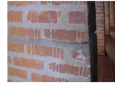
20 Grieta en un contrafuerte
