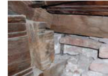
5 Pérdida por fuego (1869) de la unión entre tirantes y solera
