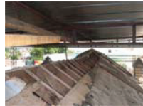
2 Desmonte parcial de la cubierta con la viga cumbreira fracturada en el medio
