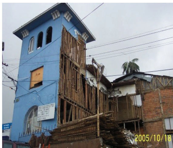
Figura 12: Bahareque de Transición Clínica Manizales. 1946. Demolida.
