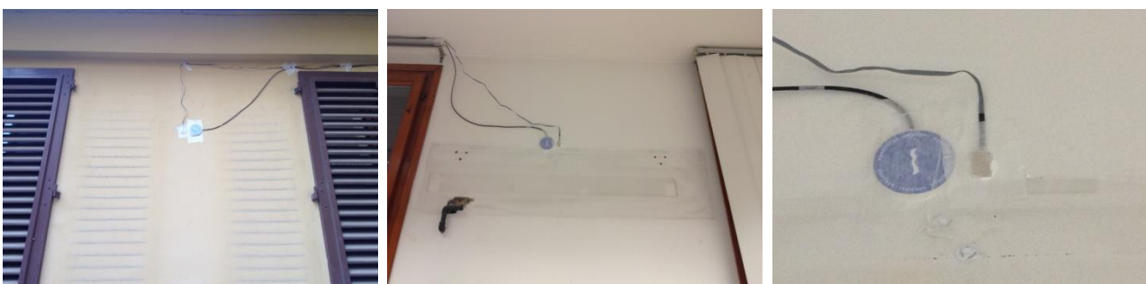
Figura 2: foto dei sensori di misura installati sulla superficie esterna (sinistra), interna (centro), e dettaglio di collocazione (destra) della parete W1
