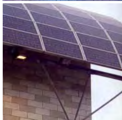
1,2,3,4 Particolari della pensilina FV
