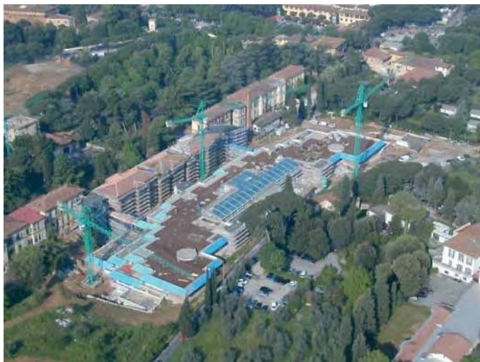
Fig. 11 - Vista del cantiere Ospedale Meyer di Firenze progetto studio CSPE di Firenze, Vista interna della serra fotovoltaica, realizzazione prevista nel 2005.
