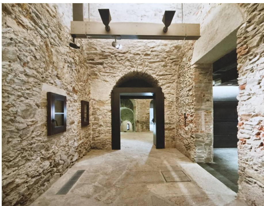
Fig. 12. Interno dell'Opera Ferdinando. Lo stato di conservazione delle superfici ha determinato soluzioni d'intervento prese 'caso per caso'. Si sono potuti mantenere gli intonaci di impianto, scabri e grossolani (tratta da: M. Venegoni, L. Italia, M. Bert, Cantiere Ferdinando. Immagini di un restauro , Duc, Saint-Christophe (Valle D'aosta), 2012.)
