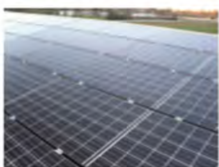
Fig. 463 Esempio di applicazione del fotovoltaico policristallino
