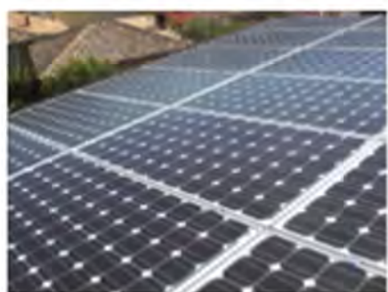
Fig. 461 Esempio di applicazione del fotovoltaico monocristallino
