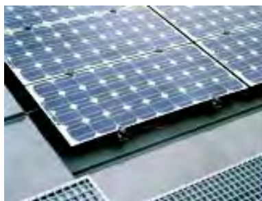
Esempi di impianti FV sovratetto
