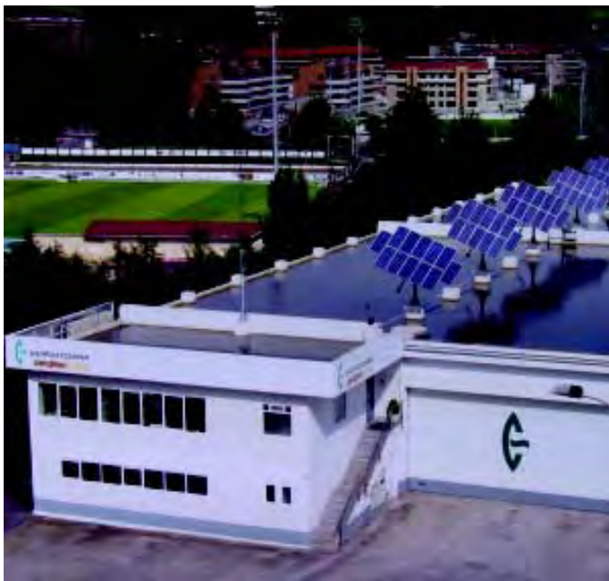
Moduli FV BP solar in copertura.
