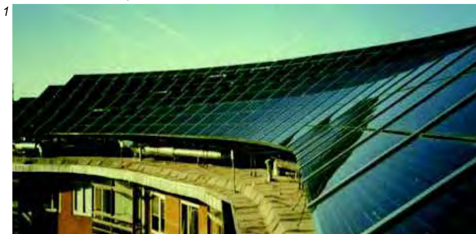
1,2 particolare dell'impianto FV posto in copertura
