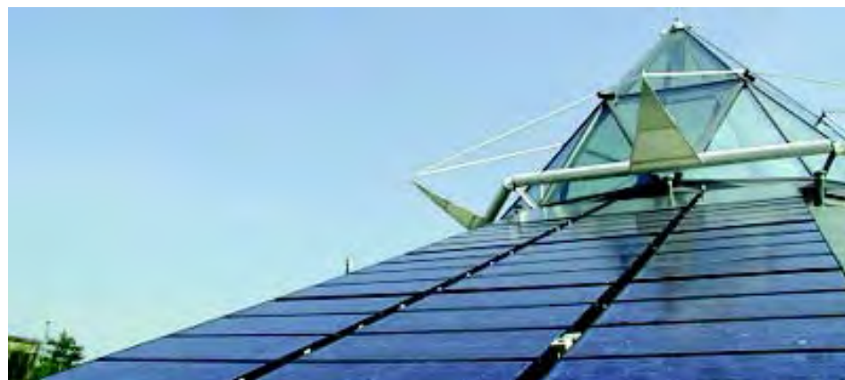
2, 3 Particolare del sistema FV integrato con pannelli solari
