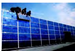
Muro fotovoltaico per Channel 4, Londra UK
