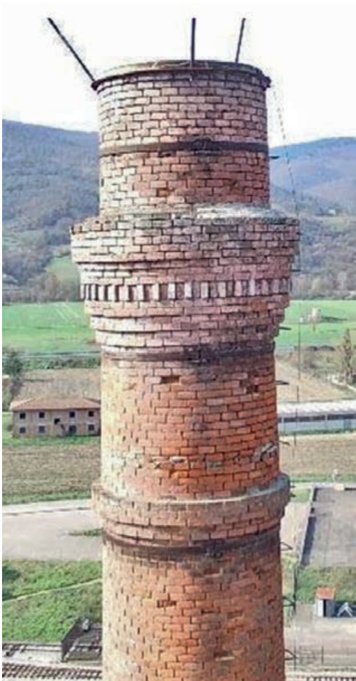
Figura 2. Diffuso stato di degrado della struttura particolarmente evidente nella parte superiore della ciminiera.
