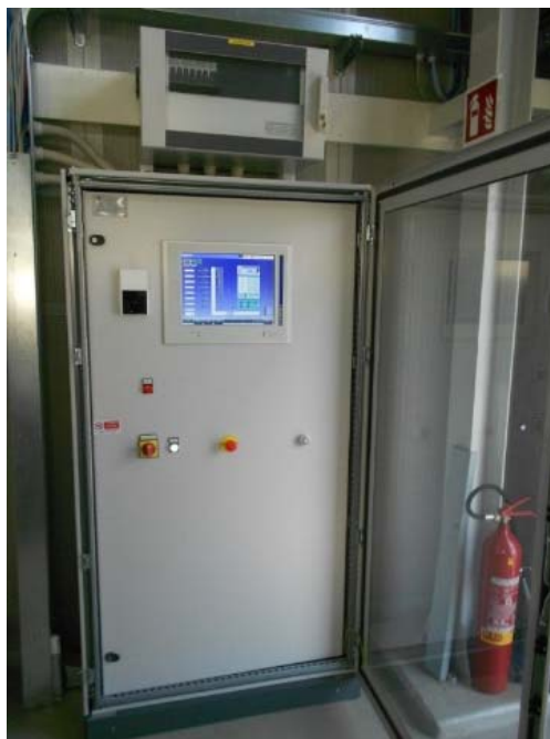
Figura 116: Quadro gestione sicurezze e centralina gas
