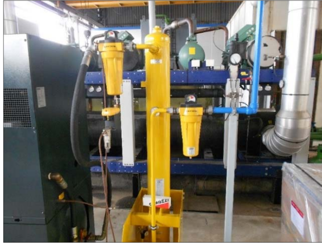
Figura 113: Compressore aria compressa, gruppo di filtrazione e piping
