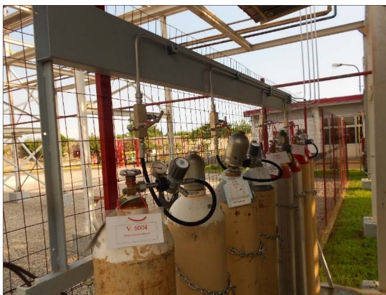
Figura 115: Bombole per i gas compressi, riduttori e valvole tipologia manifold
