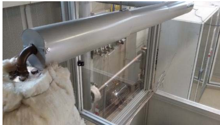
Figura 154: Tubazione coibentata in uscita all'impianto
