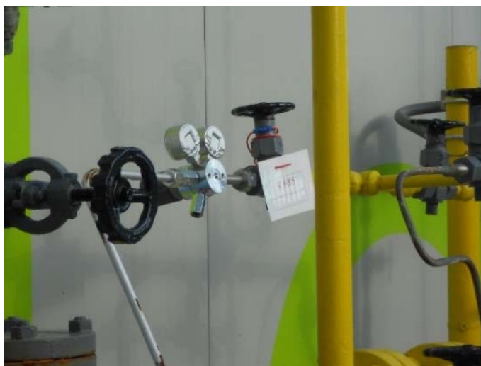
Figura 114: Riduttore di pressione per l'H2 all'esterno dell'unità R&D LAB
