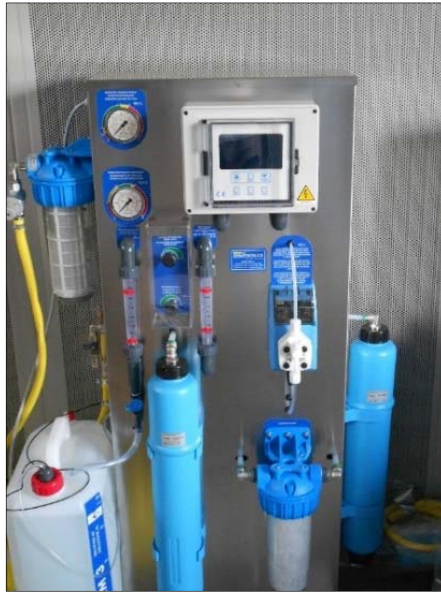
Figura 112: Demineralizzatore ad osmosi inversa e resine cationiche
