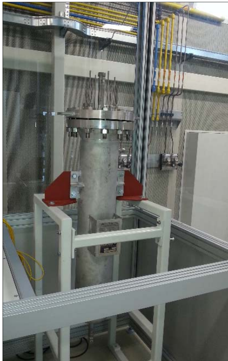
Figura 109: Skid - vista membrane
