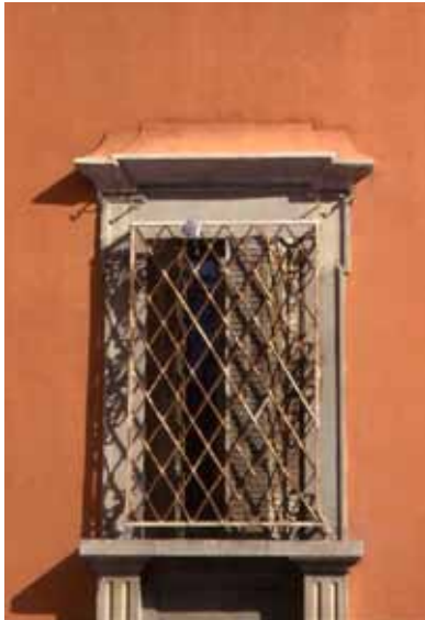
Uno dei frequenti casi in cui il raccordo sommatiale, eseguito in malta, avrebbe dovuto essere dipinto in color pietra.
