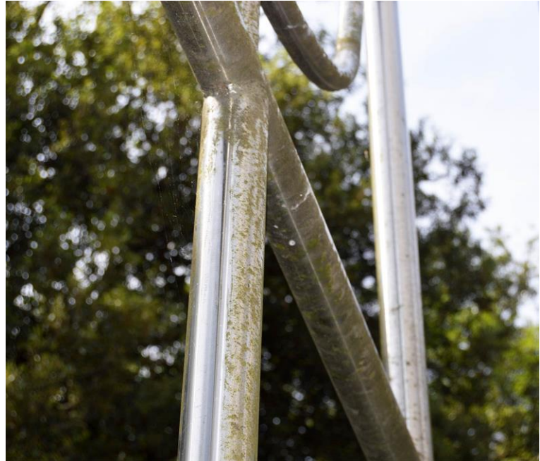
FIG.2.39: DEPOSITI SUPERFICIALI CONCENTRATI PARTICOLARMENTE NELLE FACCE ESPOSTE A SUD-EST
