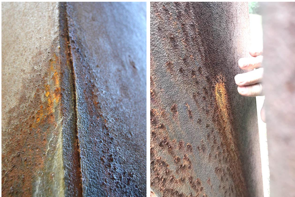
FIG.2.100: DUE IMMAGINI DI ATTACCHI CORROSIVI IN PROSSIMITÀ DELLA LESIONE
