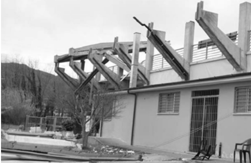
Danni provocati alle strutture dell'impianto del margine coperta dall'evento meteorologico del 5 marzo del 2015.
