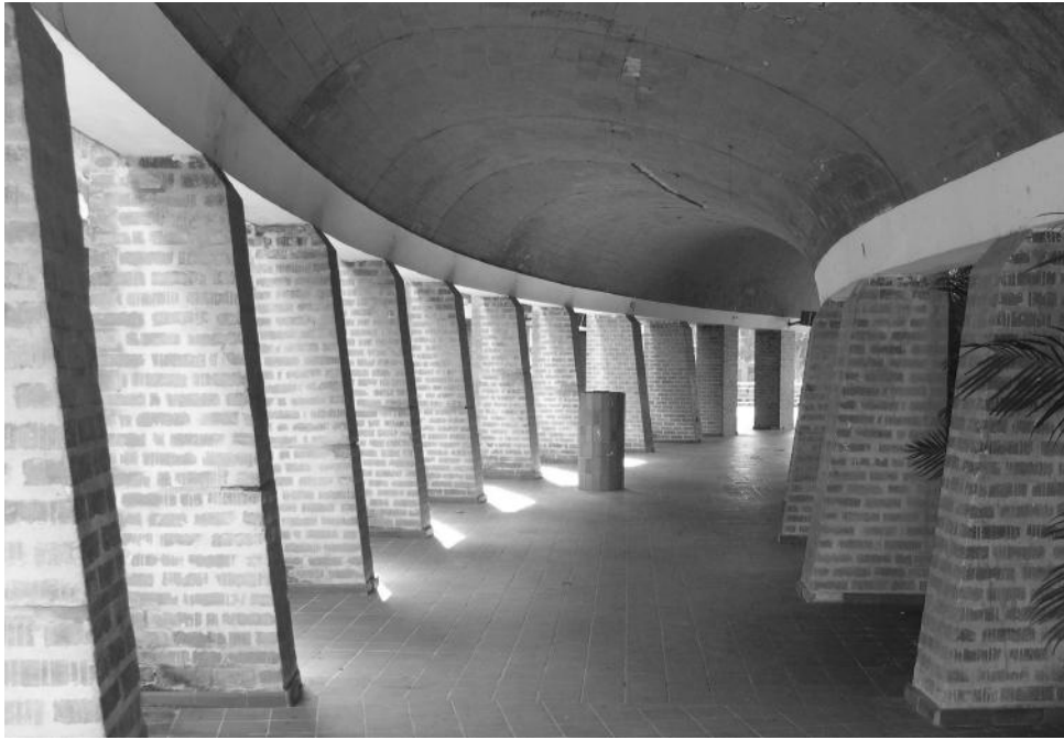
Scuola di Arti Plastiche, lesioni nei contrafforti del corridoio, 2003 (Michele Paradiso)
