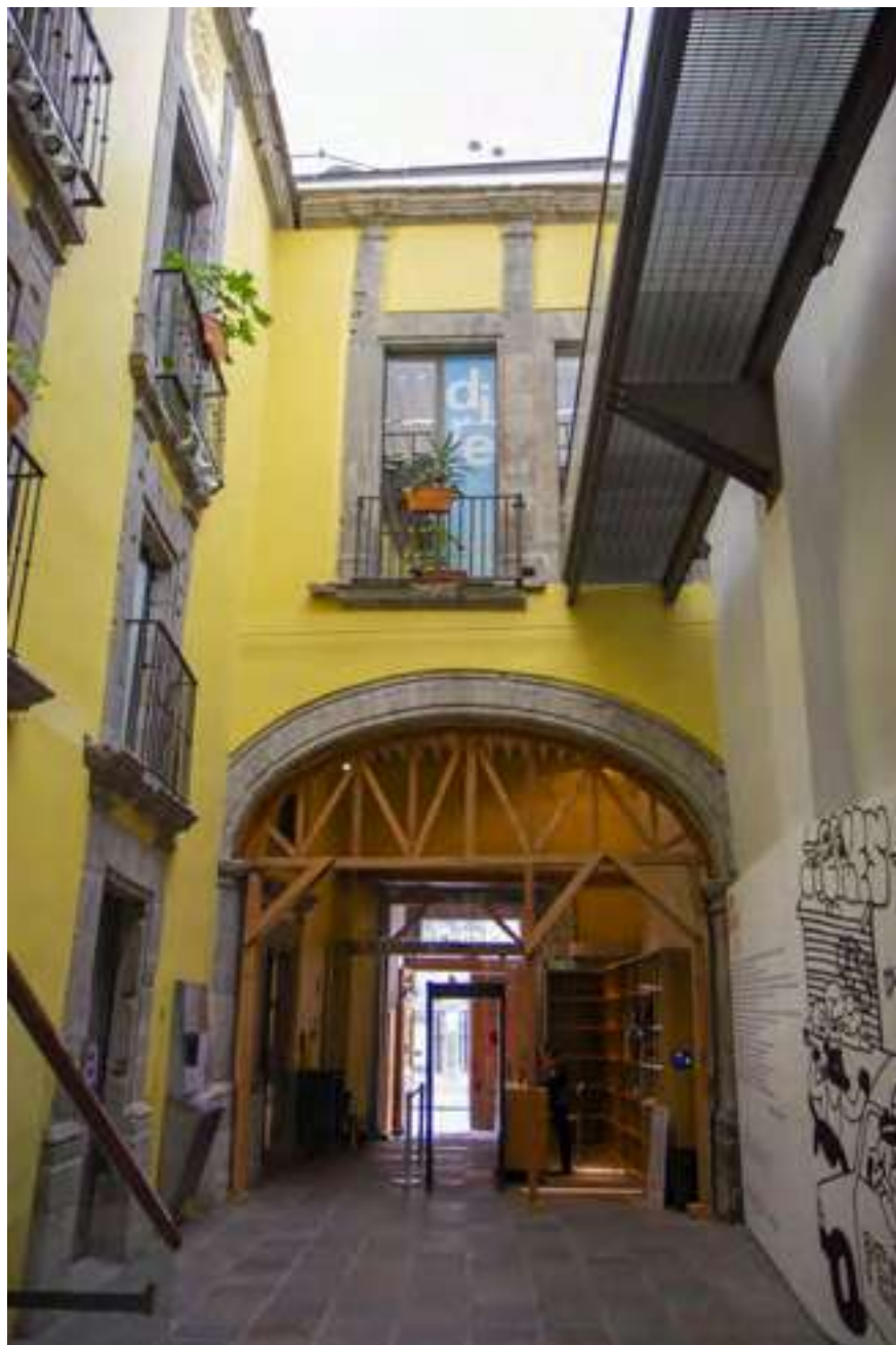
Fig.130 Nonostante siano state restaurate molte strutture in muratura presentano importanti dissesti strutturali
