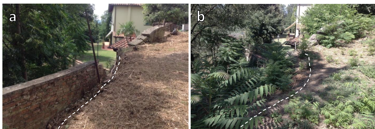
Fig. 4.26 Muro perimetrale di un giardino nei pressi di Loc. I Cappuccini: (a) foto scattata nel 2014 dove il muro appare fratturato e spanciato, (b) foto scattata nel 2016 dove il muro perimetrale è definitivamente crollato e la scarpata del movimento è arretrata all'interno del giardino.
