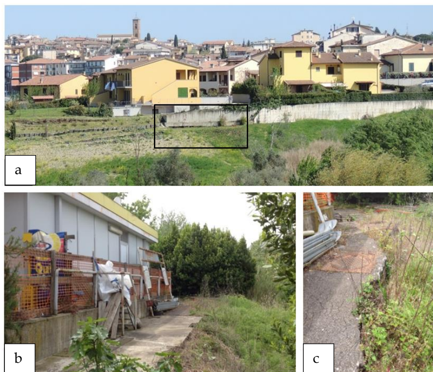
Fig. 4.15 (a) Muro perimetrale del nuovo agglomerato insediativo costruito tra 2003 e 2007 con evidenziato il settore il cui i processi erosivi e gravitativi hanno portato alla luce la testata della palificata in cemento armato, (b,c) danni indotti sull'autolavaggio dall'arretramento della scarpata principale.
