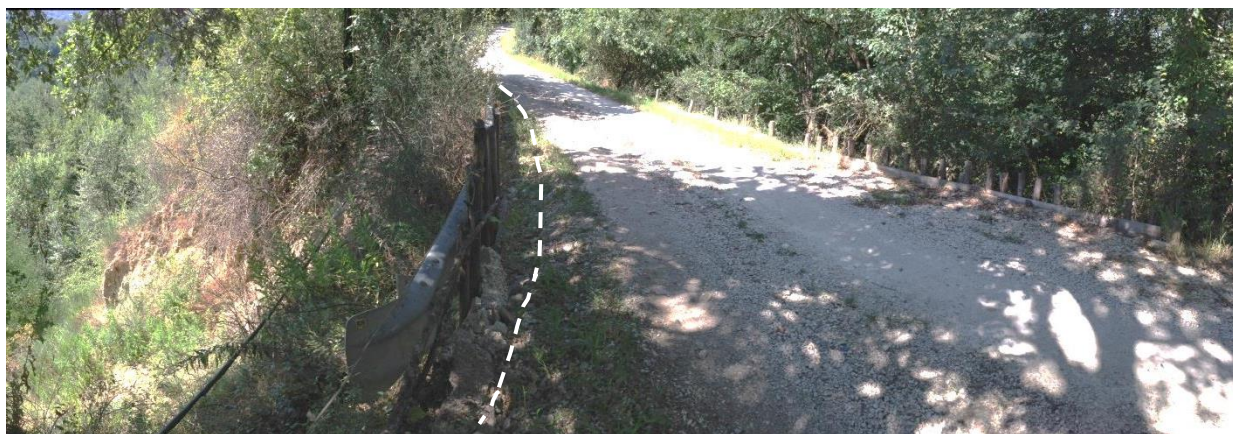
Fig. 4.32 Strada sterrata nei pressi di Loc. Il Castellaccio: l'arretramento della scarpata principale ha raggiunto il ciglio stradale e ha divelto il guard rail.
