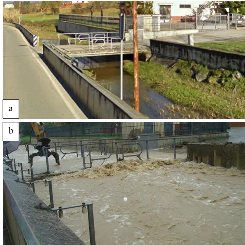
Fig.4.23 Argini artificiali lungo il Borro di Ponterosso: (a) in condizioni normali, (b) durante una piena.
