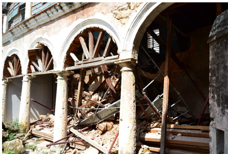
Immagine 5: Crollo del solaio del piano primo nella galleria del primo chiostro adiacente al zaguán . Fonte: G. SánchezNúñez (2012).
