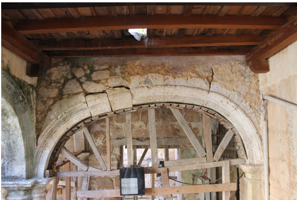
Immagine 8:Foto dell'arco nell'angolo Sud-Est nella galleria Sud dove si evidenziano fenomeni di precollasso e scivolamento a cuneo dei conci. Fonte: Garuglieri; Ferrarini (2015)
