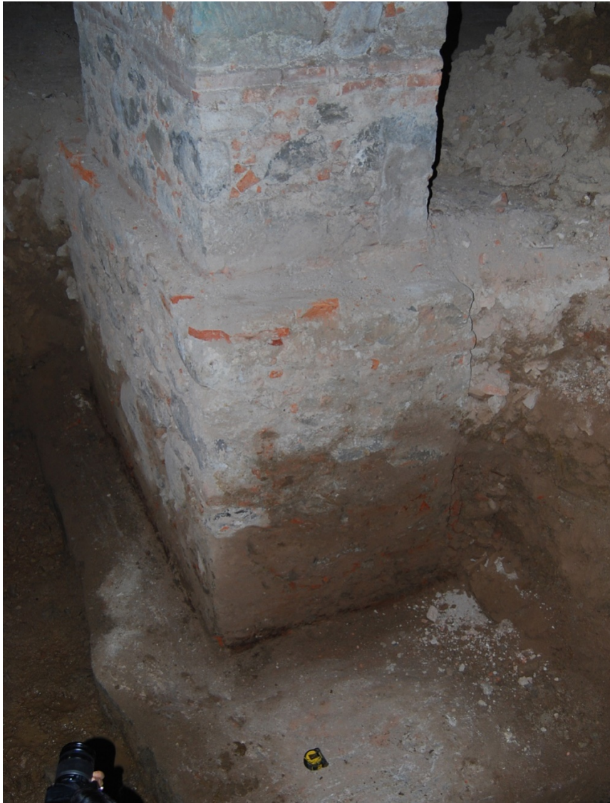
Figura 13. Saggio di fondazione su pilastro interno del setto ottocentesco. Fonte: Archivio degli autori, 2017
