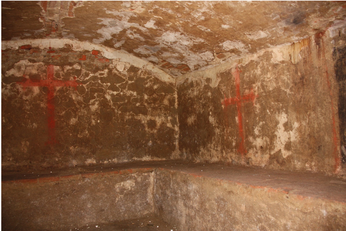
Figura 10. Ambiente ipogeo rilevato al di sotto della cappella della Santa Trinità. Fonte: Archivio degli autori, 2017
