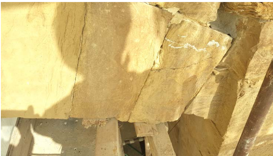
Immagine 45 - Lesioni sui conci costituenti l'arco principale
