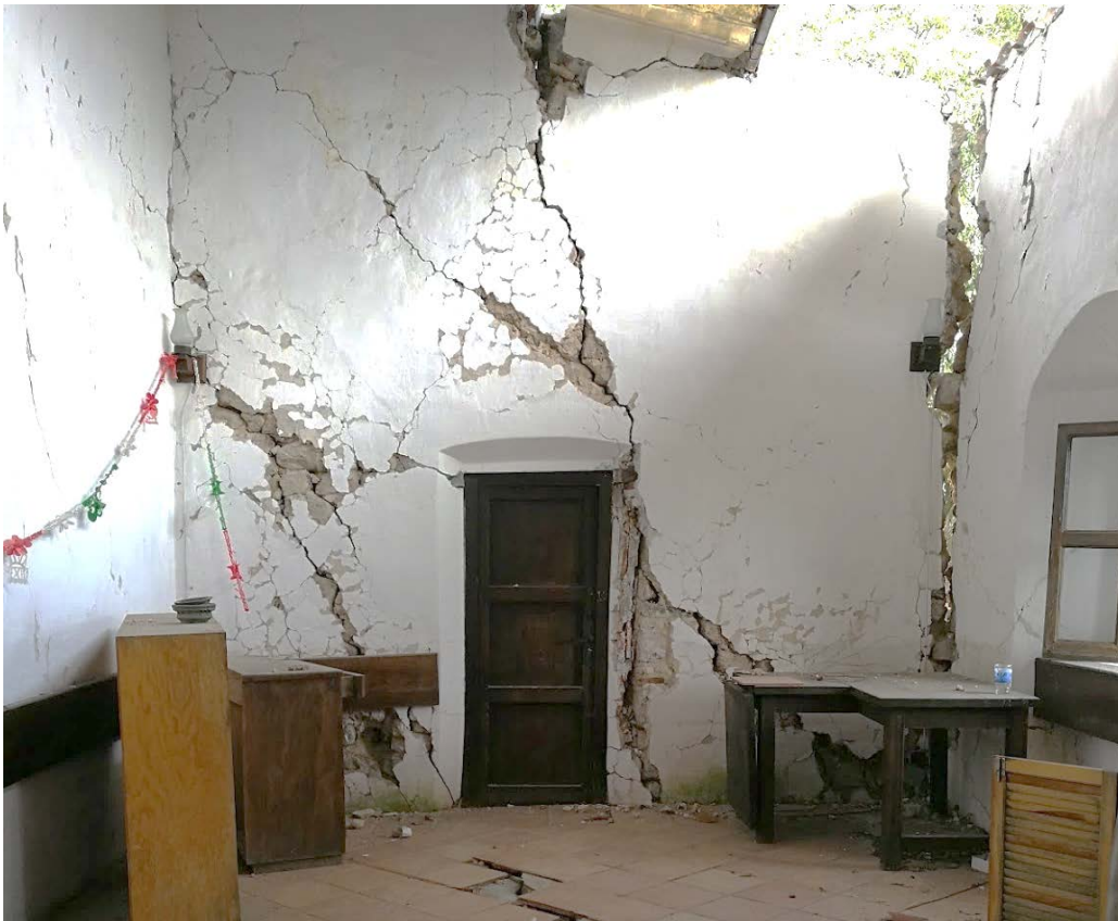
Immagine 84 - Lesioni in un ambiente del convento
