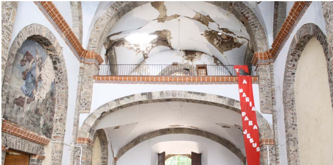
Immagine 88 - Particolare del sottocoro subito dopo il sisma, in questo momento sono presenti le strutture provvisionali
