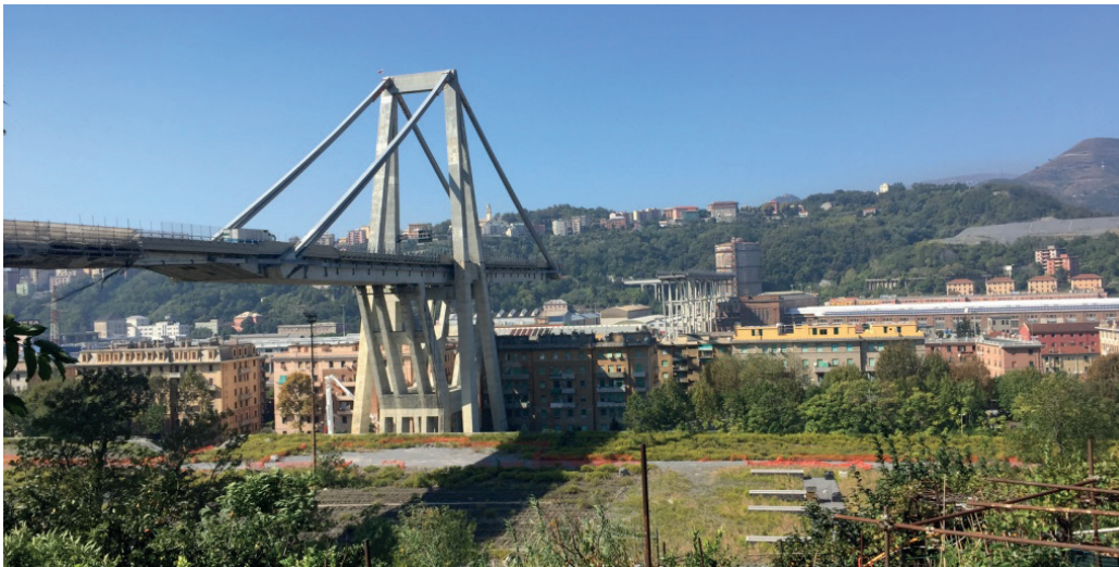
Figura 1 | I resti del Viadotto Polcevera dopo il crollo, Autore: Matilde Pitanti, 4 ottobre 2018
