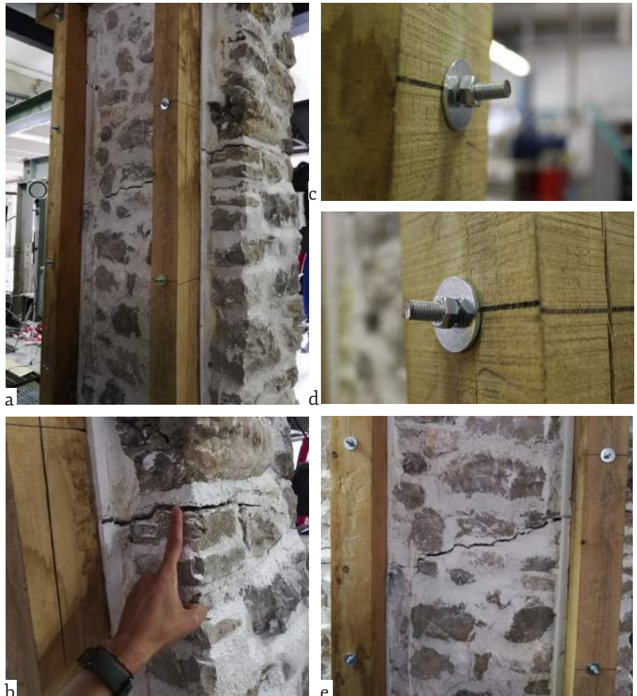
Figura 6.80 Quadro fessurativo del pannello rinforzato con un telaio ligneo (TR), Lato A (in alto). Sovrapposizione del quadro fessurativo TR e di quello della del pannello NR (indicato in nero). A sinistra: a) quadro fessurativo lato A; b) dettaglio lesione lato A-lato B; c), d) dettaglio deformazione degli ancoraggi; e) dettaglio quadro fessurativo lato A.
