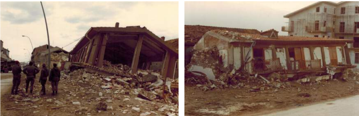
Figura 2.2 Terremoto Irpinia 1980. Lioni (AV). La sopraelevazione in cemento armato ha causato la totale disgregazione del sottostante edificio in muratura (immagini dall'archivio personale dell'autrice).
