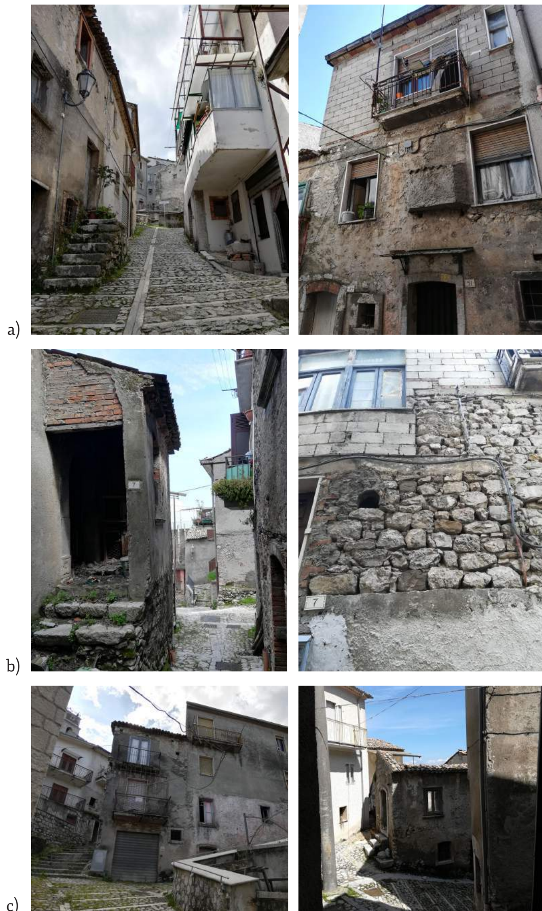
Figura 5.12 a) presenza di sopraelevazioni incongrue; b) corpi aggiunti incongrui; c) operazioni di ampliamento di aperture ed edifici in avanzato stato di degrado (immagini dell'autrice).
