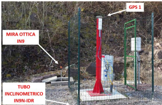
Figura 2 – Esempio di ridondanza dei sistemi di misura del movimento del dissesto di Idro (BS). Sensore GNSS con acquisizione in tempo reale, mira ottica afferente al sistema di misurazione topografica manuale e tubo inclinometrico con cavo TDR ( time domain reflectometry ). Fonte: archivio CMG Arpa Lombardia
