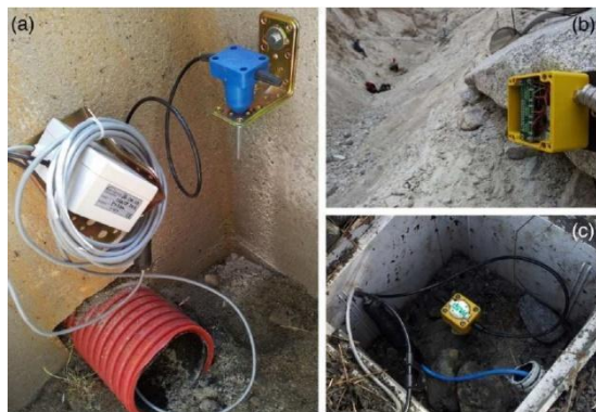
Figura A.23 - Installazione di un geofono (a) sulla parete di un pozzetto in cemento precompresso (Rio Gadria, BZ); (b) su un masso a bordo canale (Chalk Cliffs, CO, USA); (c) nel terreno sulla sponda del torrente (Rio Marderello, TO). Foto: V. Coviello
