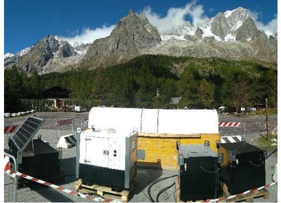
Figura A.56 - Installazione test di un modello di generatore ibrido appositamente costruito, ad alimentazione di un sistema radar interferometrico da terra. Fonte: archivio Attività geologiche – Regione Autonoma Valle d'Aosta
