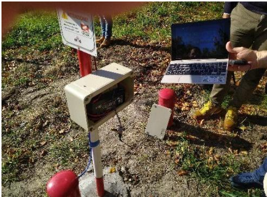
Figura 28 – Scarico dati inclinometrici da sensore servo-accelerometrico biassiale. Fonte: archivio ARPAL
