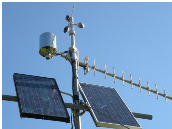
Figura 49 – Esempio rappresentativo di impianto con pannelli fotovoltaici, ampliato nel corso del tempo. Fonte: archivio Attività geologiche – Regione Autonoma Valle d'Aosta
