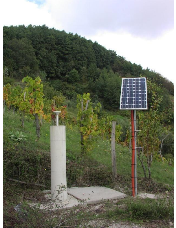
Figura 7 – Monitoraggio in modalità statica con acquisizione in continuo (Frana di Lago, CS). Fonte: archivio GEO-GFI ISPRA
