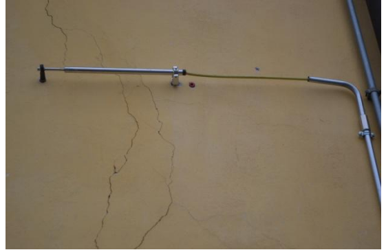
Figura A.4 - Fessurimetro elettrico a controllo di una serie di crepe sulla chiesa parrocchiale di Dossena (BG). Fonte: archivio CMG Arpa Lombardia
