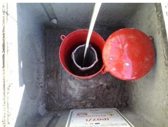
Figura A.29 - Pozzetto di protezione carrabile per testa di tubo inclinometrico. Fonte: archivio ARPAL
