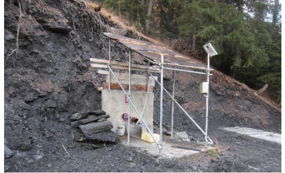
Figura 47 – Fase di costruzione di un monitoraggio idrogeologico, che integra nella platea la parte di cavi e cablaggi. Fonte: archivio Attività geologiche – Regione Autonoma Valle d'Aosta
