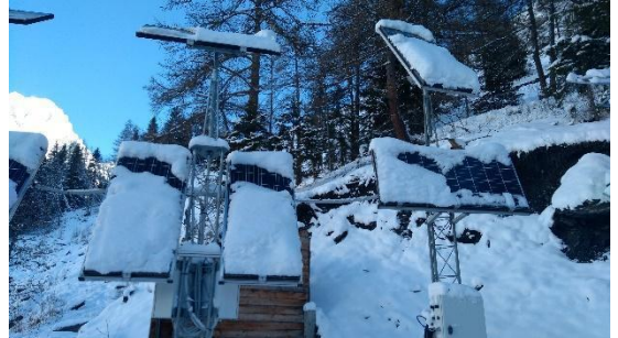
Figura A.53 - Tipico problema di zone di alta montagna, in cui i pannelli possono essere ricoperti di una coltre nevosa che ne impedisce il corretto funzionamento. Fonte: archivio Attività geologiche – Regione Autonoma Valle d'Aosta
