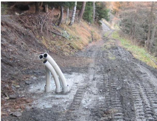
Figura 46 – Esempio di passacavo interrato per ottimizzare alcune installazioni particolarmente complesse. Fonte: archivio Attività geologiche – Regione Autonoma Valle d'Aosta
