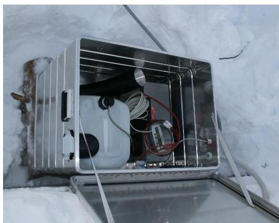
Figura A.54 - Esempio di utilizzo di una cella a combustibile (metanolo) per alimentazione di backup in zone di alta montagna. Fonte: archivio Attività geologiche – Regione Autonoma Valle d'Aosta
