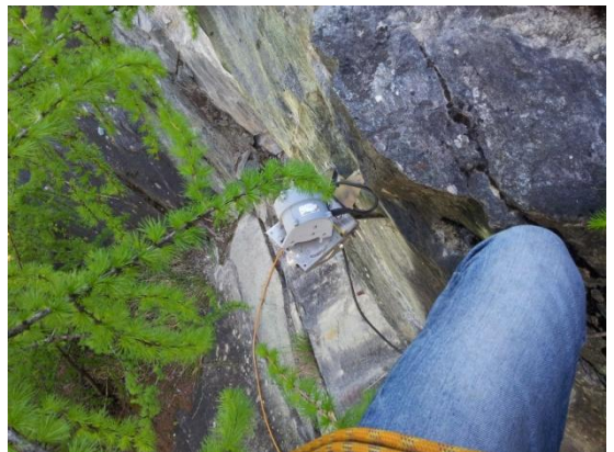
Figura A.7 - Clinometro da parete installato a controllo della parete del Sasso del Cane (Comune di Chiesa in Valmalenco – SO). Fonte: archivio CMG Arpa Lombardia
