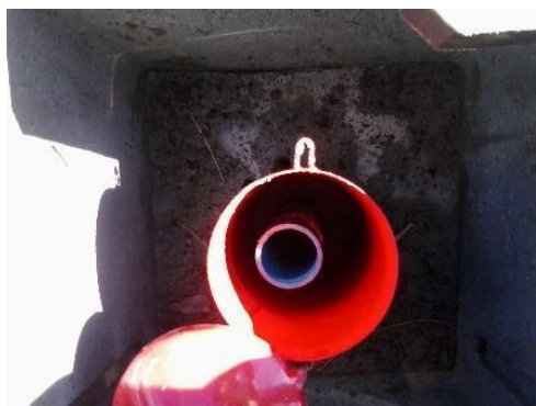
Figura A.41 - Pozzetto di protezione carrabile per testa di tubo piezometrico. Fonte: archivio ARPAL
