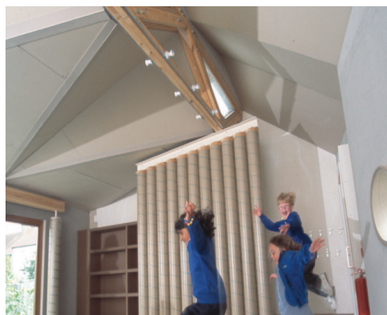
Fig.87 - Vista interna dell'aula; il cartone è stato utilizzato non solo come materiale strutturale, ma anche – dove possibile – per gli impianti, le finiture interne e i sistemi di partizione (Credits: © Peter Grant da www.cv-arch.co.uk/ )
