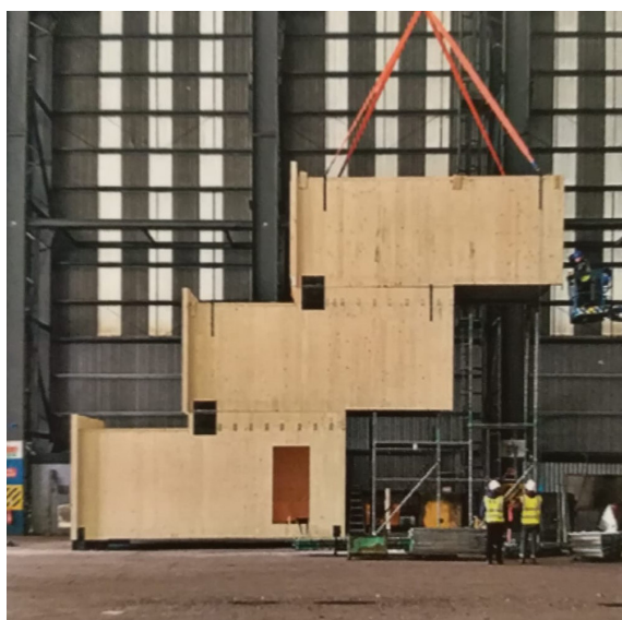
Fig.92 - Fasi di test strutturale di soluzioni aggregative per il progetto dello Student Village a Malmesbury (WilkinsonEyre, 2020) (Credits: © WilkinsonEyre da Detail , 6/2020)
