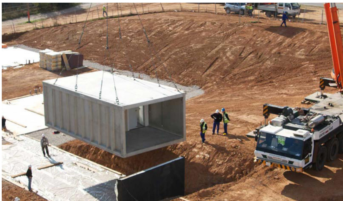
Fig.95 - Unità modulari prefabbricate con struttura monolitica in calcestruzzo armato (Credits: Compact Habit® da www.compacthabit.com )
