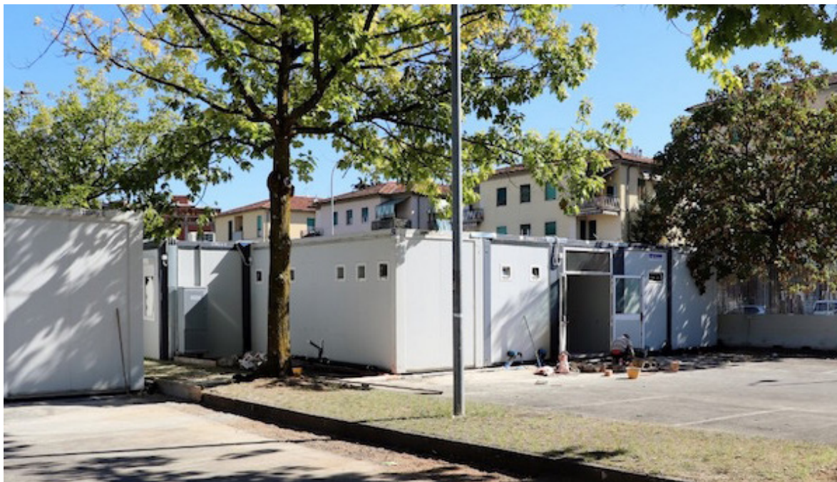
Fig.46 - Vista esterna dell'ampliamento della Scuola Secondaria "Paladini e Civitali" realizzato attraverso l'installazione di unità modulari in un'area di parcheggio in prossimità della scuola esistente (Credits: Provincia di Lucca, 2018 da www.gonews.it )
