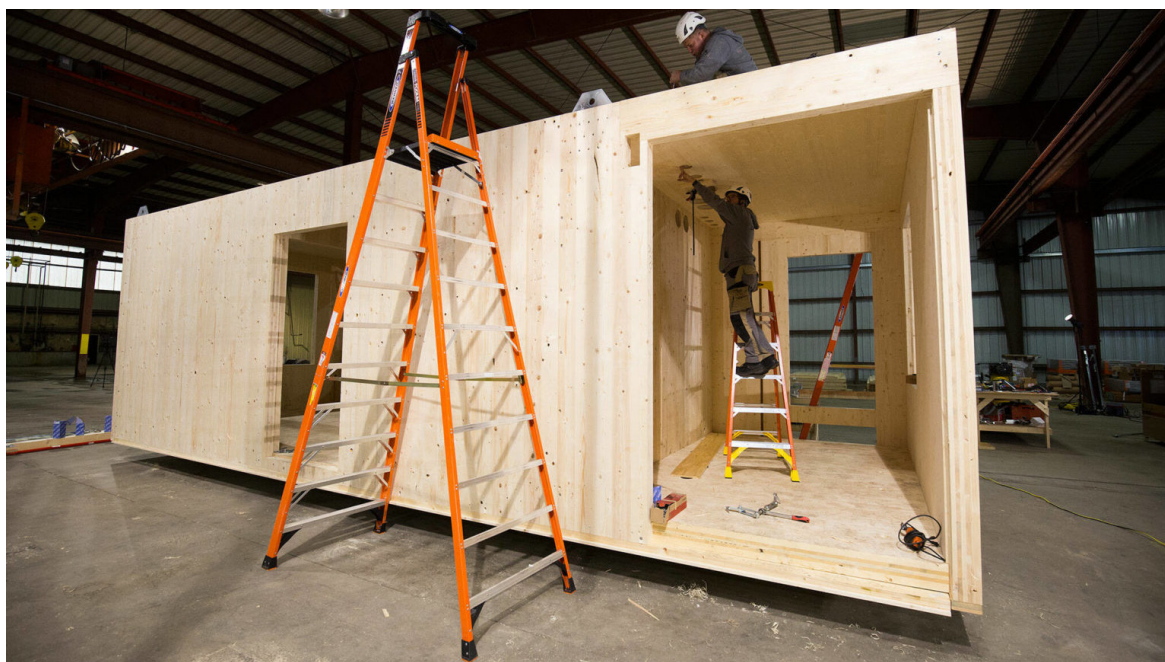
Fig.91 - Produzione di unità modulari con struttura CLT a Marine View Drive (Everett, WA, USA) (Credits: © Andy Bronson/The Herald da www.heraldnet.com )
