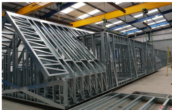
Fig.85 - Modulo di copertura pre-assemblato in officina (Credits: LGSF Solutions in Steel da lgsf.co.uk )
