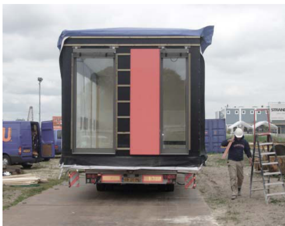
Fig.83 - Le unità modulari sono state pre-assemblate e completate con finiture e impianti, quindi trasportate in sito per l'installazione (Credits: Foto di © Lorenzo Calistri, HVDN architecten design team (Albert Herder, Arie van der Neut) da www.indire.com )
