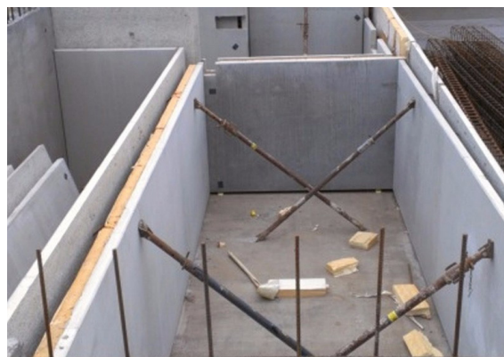
Fig.124 - Struttura realizzata con pannelli prefabbricati in calcestruzzo, da integrare con getto di completamento in opera (Credits: Keegan Precast da www.keeganprecast.com)
