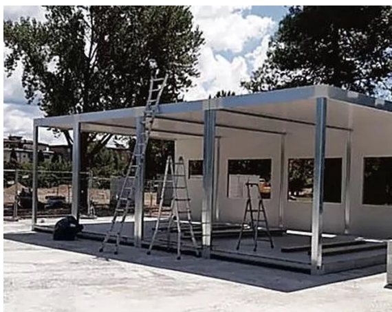
Fig.44 - Fasi di installazione dei moduli prefabbricati (Credits: © Katia Bernardeschi da Il Tirreno: www.iltirreno.gelocal.it )
