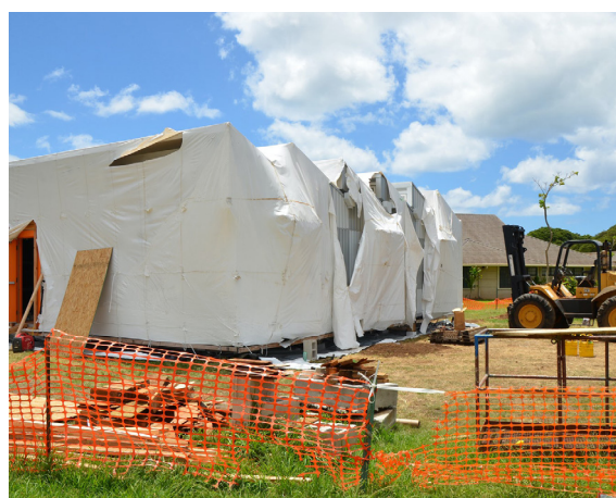
Fig.60 - Fasi di installazione in sito della Energy-Positive Relocatable Classroom (Credits: © Anderson Anderson Architecture da www.architizer.com )
