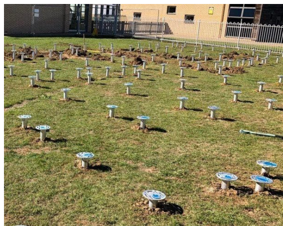
Fig.54 - Le unità modulari sono installate su un sistema di fondazione a viti in acciaio prefabbricato e reversibile, che consentirà in futuro di rinaturalizzare il sito (Credits: Green Modular da www.green-modular.com )
