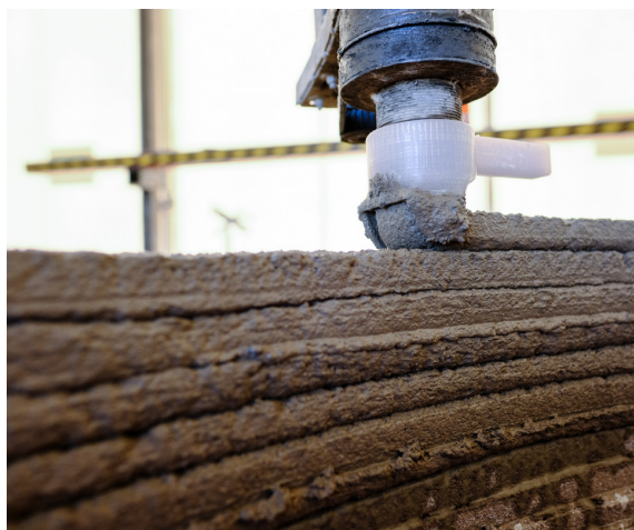
Fig.131 - Lo stampaggio può impiegare calcestruzzo o miscele naturali a base di terra cruda (Credits: © COBOD da cobod.com)
