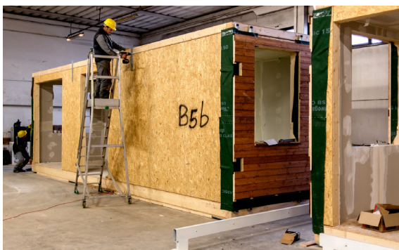
Fig.89 - Assemblaggio e completamento off-site delle unità modulari (Credits: Campigli Legnami da www.campigillegnami.it )
