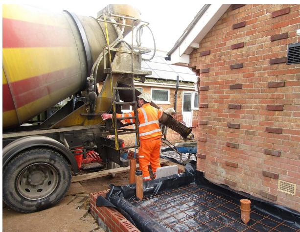
Fig.7 - L'approccio tradizionale alle costruzioni prevede di sviluppare tutte le sequenze realizzative in opera. Nell'immagine, un operatore si appresta ad eseguire un getto di calcestruzzo in cantiere (Credits: © Kolfor, 2010 da commons.wikimedia.org (Creative Commons Licence))
