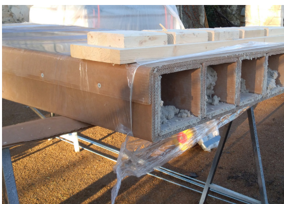
Fig.128 - I pannelli vengono completati off-site prevedendo l'insufflaggio di materiale isolante sfuso (Credits: Foto personale, 2020)
