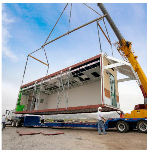
Fig.83 - Fasi di movimentazione e installazione di unità modulari LSF: la struttura portante deve essere dimensionata per resistere ai carichi dinamici durante la messa in opera (Credits: American Modular System da inhabitat.com)
