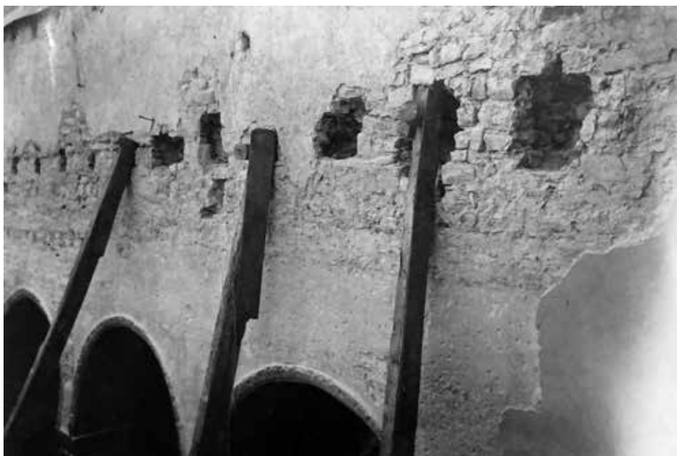
Parenzo, basilica Eufrosiana, lato sinistro della navata centrale, particolare delle murature in cattive condizioni e aperte da molti varchi, 1928 (da Roma, ACS, AA.BB.AA., Div.II, b. 288)
