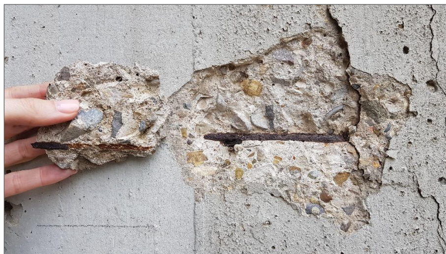
Figura 2.5. Firenze, Sorgane, edificio A (1981) Dettaglio del fenomeno di spalling causato della corrosione della staffa, in presenza di copriferro carbonatato (foto M. Castellini 2021).
