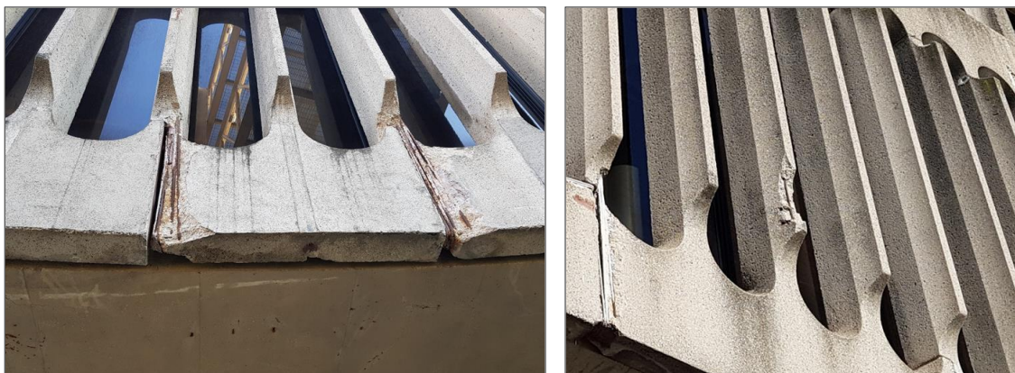
Figura 7.7. Dettagli dei fenomeni di espulsione del copriferro.
