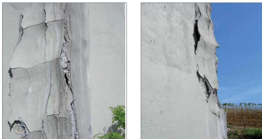
Figura 2.13. Esempio di struttura interessata da attacco solfatico, con dettagli dei rigonfiamenti e conseguenti delaminazioni in atto (foto da www.mapei.com , cons. 03/01/2024).
