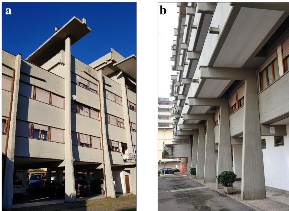
Figura 3.9. a) elementi strutturali a vista esposti alla pioggia battente; b) strutture in elevazione esposte all'esterno, ma prevalentemente riparate dalle piogge.
