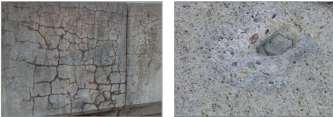
Figura 2.15. a) map cracking del cls dovuto all'innesco di reazioni alcali-silice; b) dettaglio dell'espulsione di un aggregato dovuto al fenomeno di pop-out (da www.usa.sika.com , cons. 03/01/2024).
