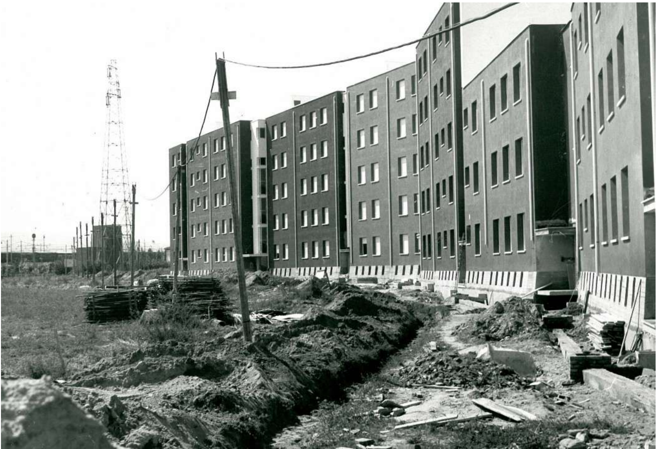
Fig. 6 Cantiere dell'edificio di Glauco Gresleri al Pilastro, 1965. Archivio privato di Glauco Gresleri.
